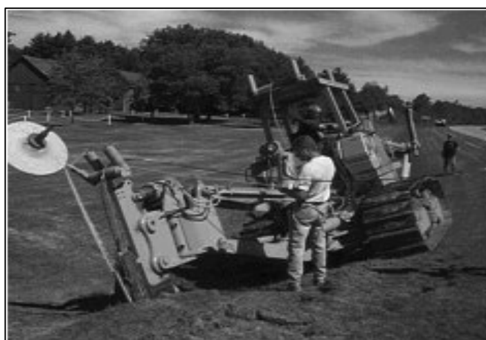
Figura 3 Cables enterrados. Fuente. Adaptado de Cables enterrados [Fotografía], por The Fiber Optic Association, 2016, FOA ( https://foa.org/ESP-Design/CH5.htm ).
