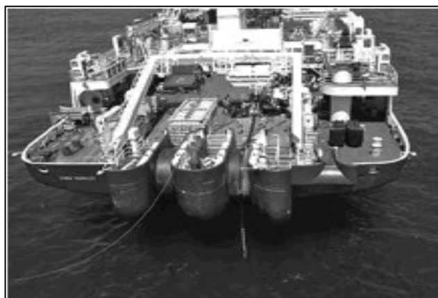
Figura 5 Cableado bajo el agua. Fuente. Adaptado de Cableado bajo el agua [Fotografía], por The Fiber Optic Association, 2016, FOA ( https://foa.org/ESP-Design/CH5.htm ).
