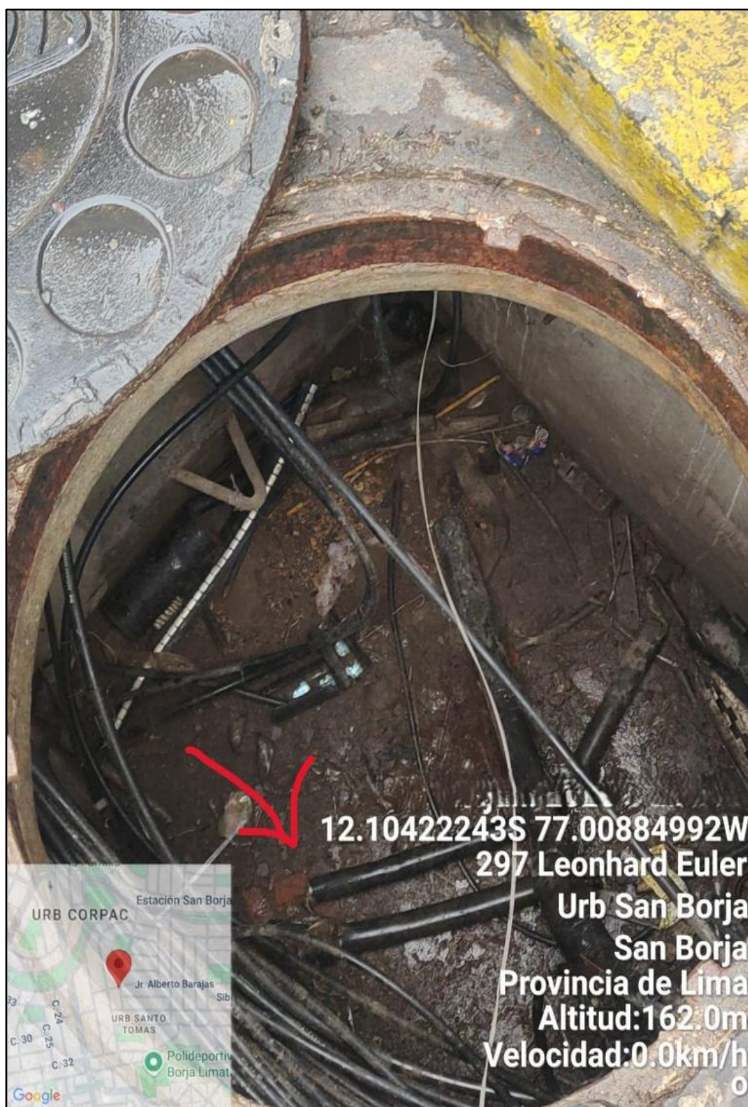
Figura B.3 Evidencia de un 2º robo de cobre. Fuente. Adaptado de la plataforma interna de datos de la empresa de telecomunicaciones.
