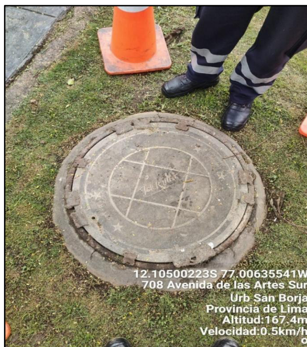
Figura B.1 Buzón de cable de cobre. Fuente. Adaptado de la plataforma interna de datos de la empresa de telecomunicaciones.
