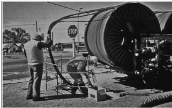
Figura 2 Cables subterráneos. Fuente. Adaptado de Cables subterráneos [Fotografía], por The Fiber Optic Association, 2016, FOA ( https://foa.org/ESP-Design/CH5.htm ).
