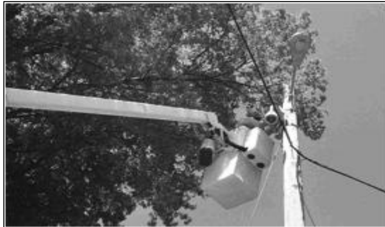
Figura 4 Cables aéreos. Fuente. Adaptado de Cables aéreos [Fotografía], por The Fiber Optic Association, 2016, FOA ( https://foa.org/ESPDesign/CH5.htm ).
