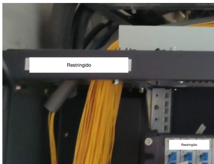
Figura 38: Etiquetado del ODF Huawei. Fuente: Elaboración Propia
