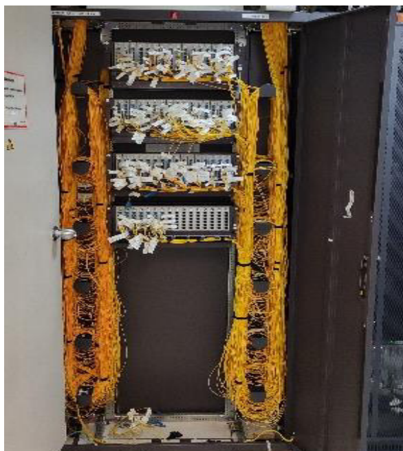
Figura 39: ODF's Huawei agrupados en un único gabinete. Fuente: Elaboración Propia
