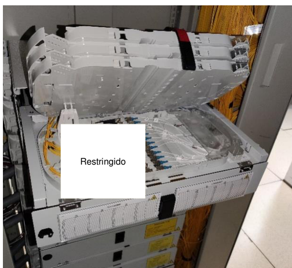
Figura 26: Interior del ODF - GPS2. Fuente: Elaboración Propia
