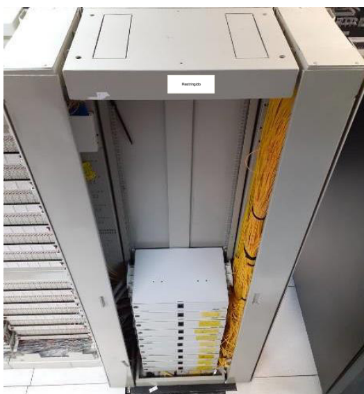
Figura 23: Gabinete sin puerta con ODF – GPS2's instalados. Fuente: Elaboración Propia
