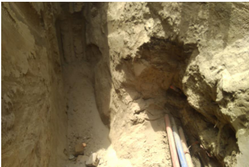
Figura 18: Cables Eléctricos encontrados al construir ducterías. Fuente: Elaboración Propia
