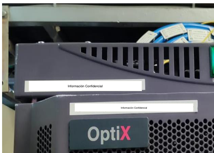
Figura 33: Etiquetados en el gabinete de los equipos DWDM. Fuente: Elaboración Propia
