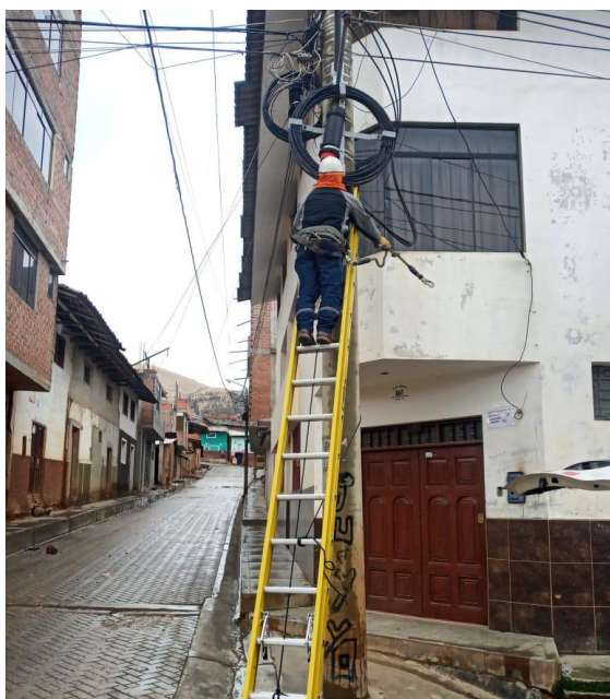
Figura 15: Poste de alumbrado público denso de cables de F.O. Fuente: Elaboración Propia
