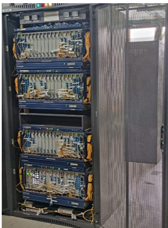
Figura 36: Gabinete con 4 subracks OSN9800UPS. Fuente: Elaboración Propia
