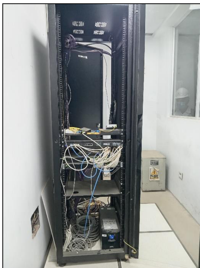
Figura 8 Gabinete principal de telecomunicaciones. Fuente. Laboratorios SMA (2025)
