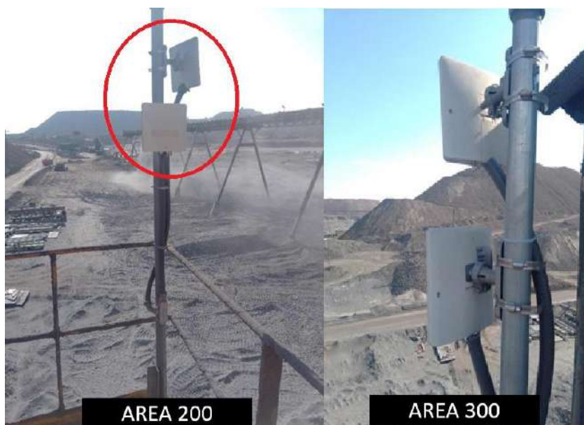
Figura 38: Antenas montadas en el área 200 y 300. Fuente: Elaboración propia (2025).
