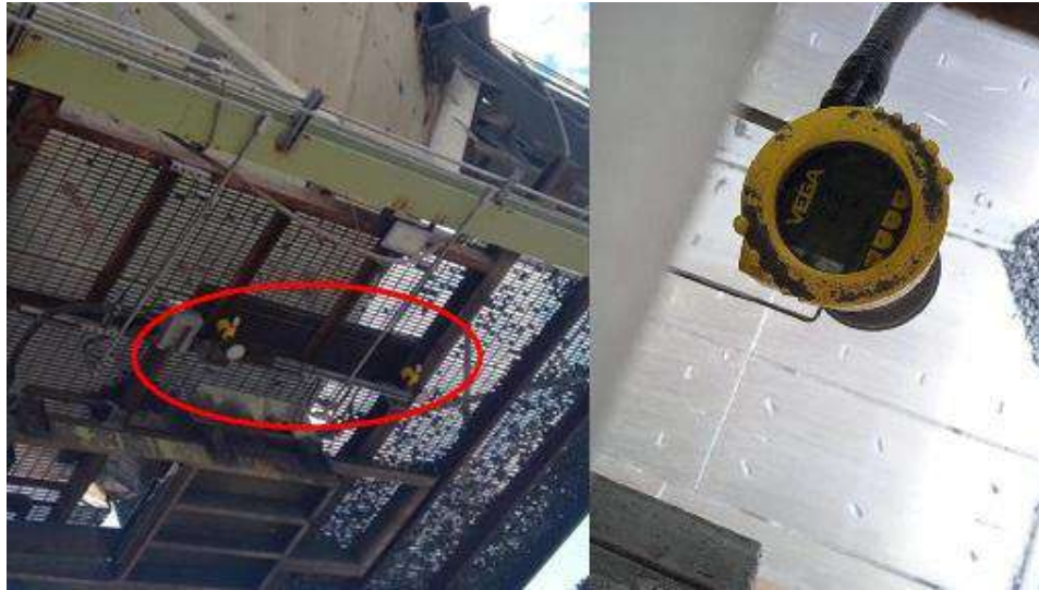
Figura 40: Transmisores de nivel LIT10002 y LIT10003. Fuente: Elaboración propia (2025).
