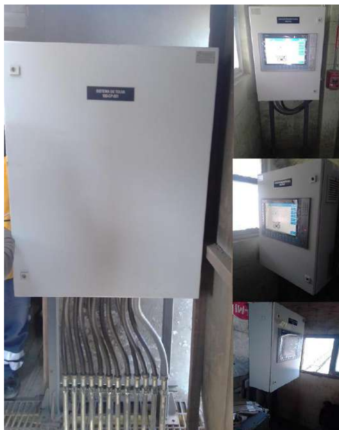
Figura 36: Tableros montados en sus áreas respectivas. Fuente: Elaboración propia (2025).
