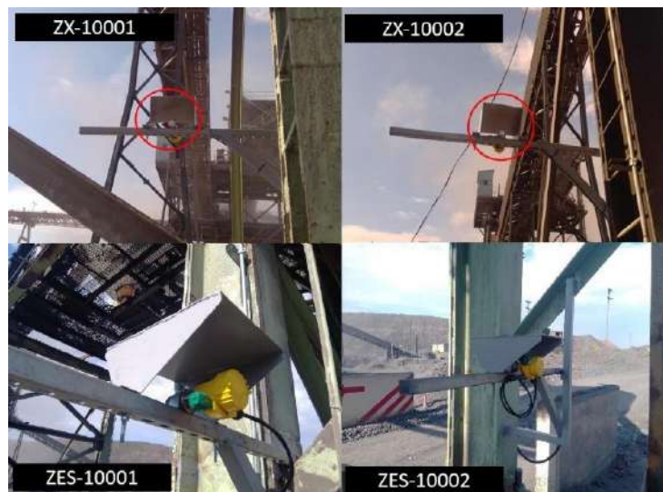
Figura 42: Sensores emisores y receptores para detección de posición. Fuente: Elaboración propia (2025).
