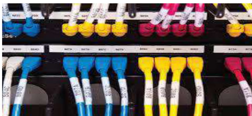
Figura 9 Rotulación de cableado y conexiones (Fuente: Internet)
