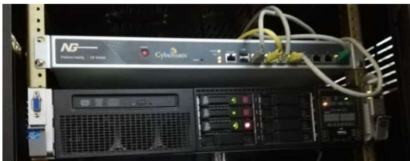
Figura 8 Cables no rotulados (Fuente: Elaboración Propia)
