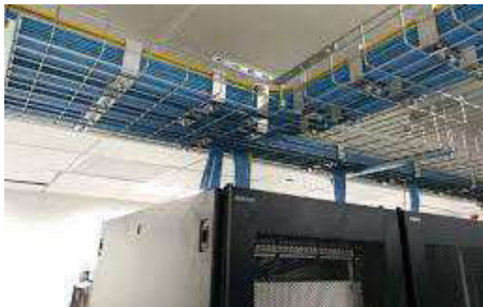
Figura 33 Bandeja Porta Cables (Fuente: Fabricante)
