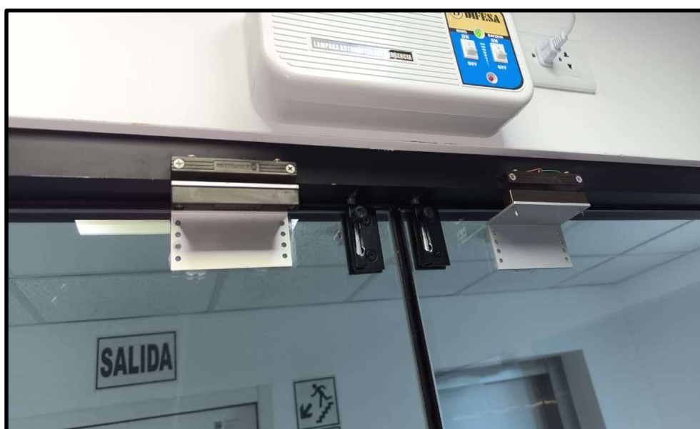
Figura 56 Contacto magnético semipesado. Fuente. Fotografía tomada durante la instalación. Fuente: Elaboración propia a partir de registro fotográfico tomado por Ángel Guerrero (2025).
