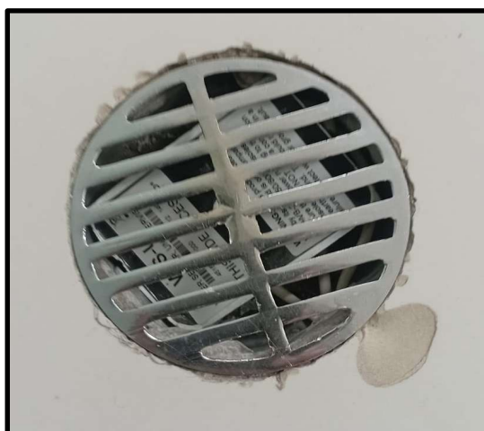
Figura 63 Sensor de aniego instalado con rejilla. Fuente. Elaboración propia a partir de registro fotográfico tomado por Richard Huamaní (2025).
