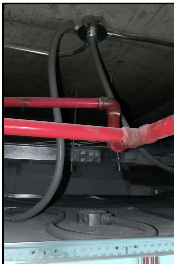
Figura 49 Montaje de dispositivos en baldosa techo. Fuente: Elaboración propia a partir de registro fotográfico tomado por Ángel Guerrero (2025).
