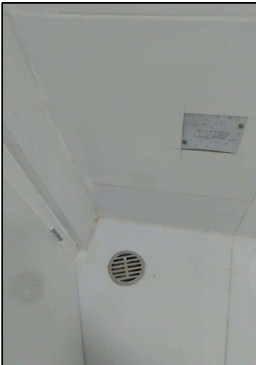
Figura 64 Sensor de aniego y caja de paso. Fuente: Elaboración propia a partir de registro fotográfico tomado por Richard Huamaní (2025).
