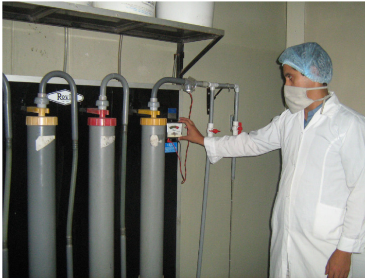
Imagen N°3.1 – Tratamiento de Aguas con Equipo desmineralizador
