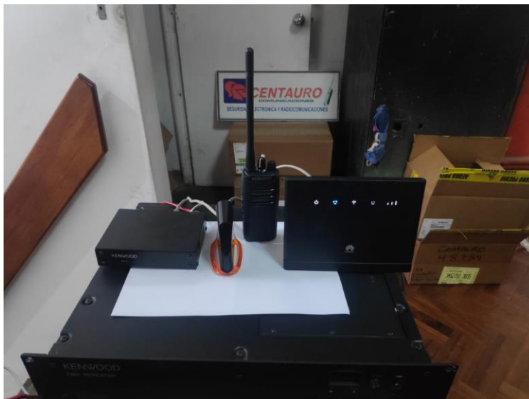
Figura 34. Implementación del sistema de repetidora REP_2 con enlace LTE, parte frontal. Fuente. Propia
