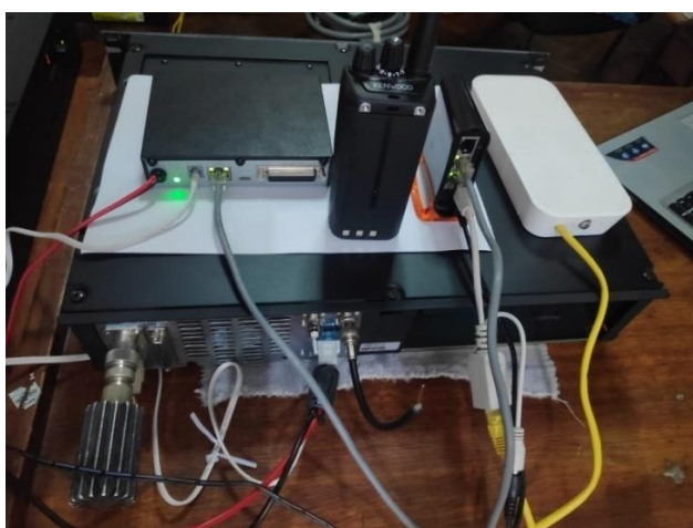
Figura 33. Implementación del sistema de repetidora REP_1 con enlace LTE, parte posterior. Fuente. Propia
