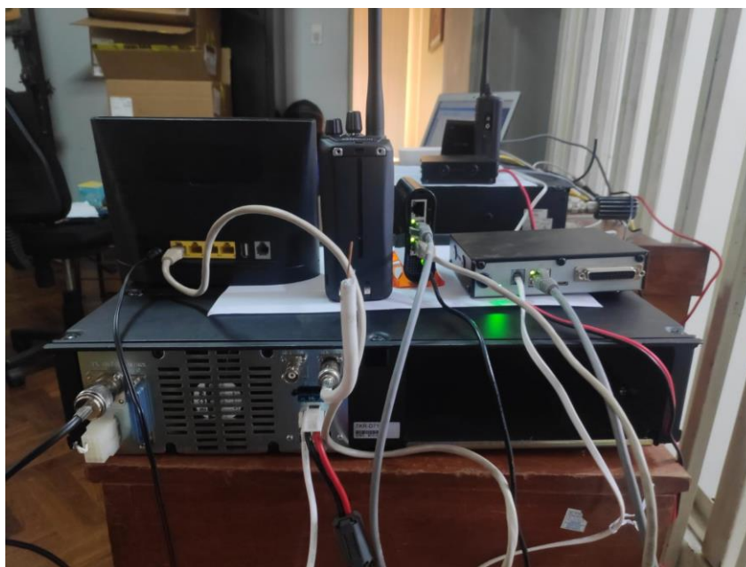
Figura 35. Implementación del sistema de repetidora REP_2 con enlace LTE, parte posterior. Fuente. Propia
