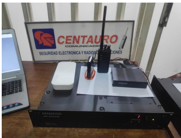
Figura 32. Implementación del sistema de repetidora REP_1 con enlace LTE, parte frontal. Fuente. Propia
