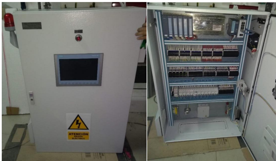
Figura 13: Fotos del tablero remoto I/O 1624-RIO-001. Fuente: Elaboración propia.
