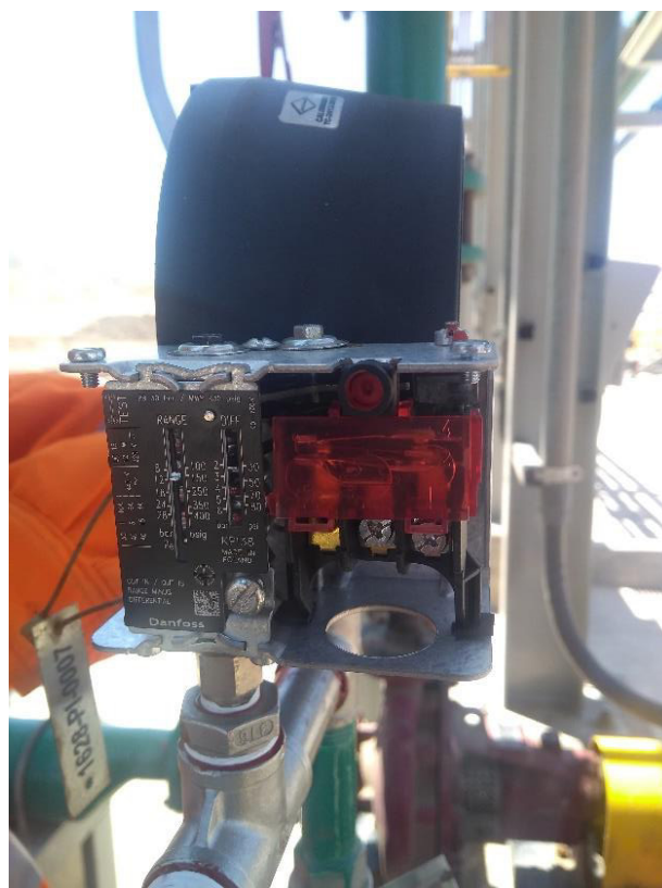
Interruptor de presión alta 1628-PSH-0002. Fuente: Elaboración propia
