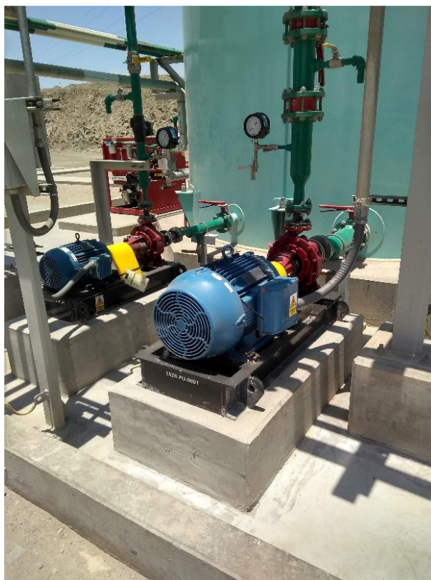
Bombas de lavado 1628-PU-0001 y 1628-PU-0002. Fuente: Elaboración propia
