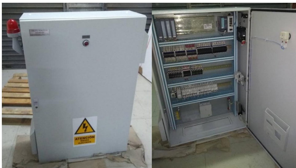
Figura 14: Foto del tablero remoto I/O 1628-RIO-001. Fuente: Elaboración propia.
