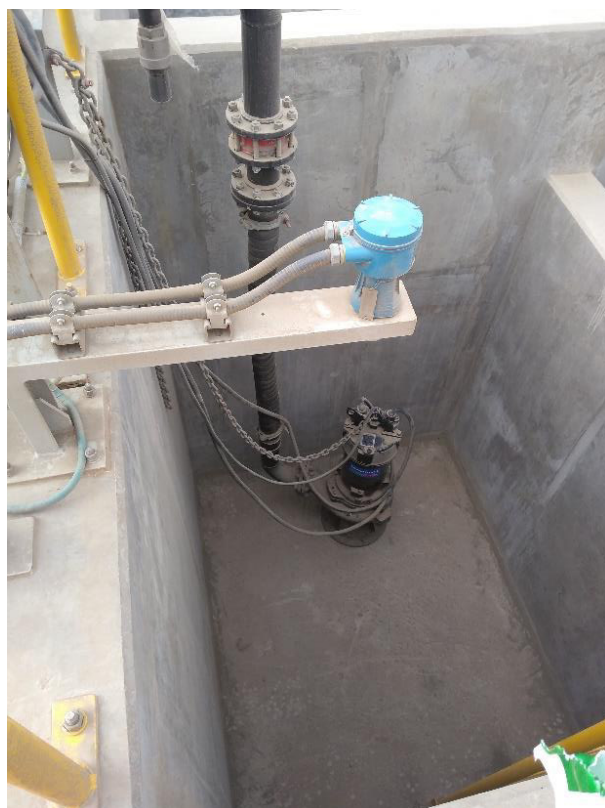
Bomba de recuperación 1628-PU-0003. Fuente: Elaboración propia
