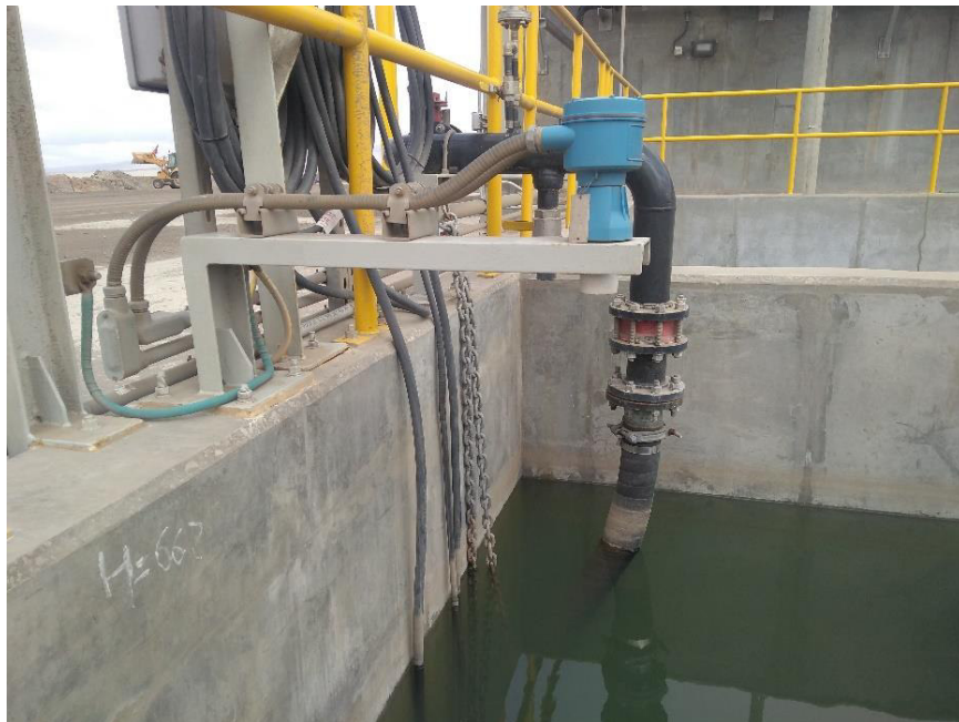
Interruptor de nivel 1628-LSL/H-0010. Fuente: Elaboración propia
