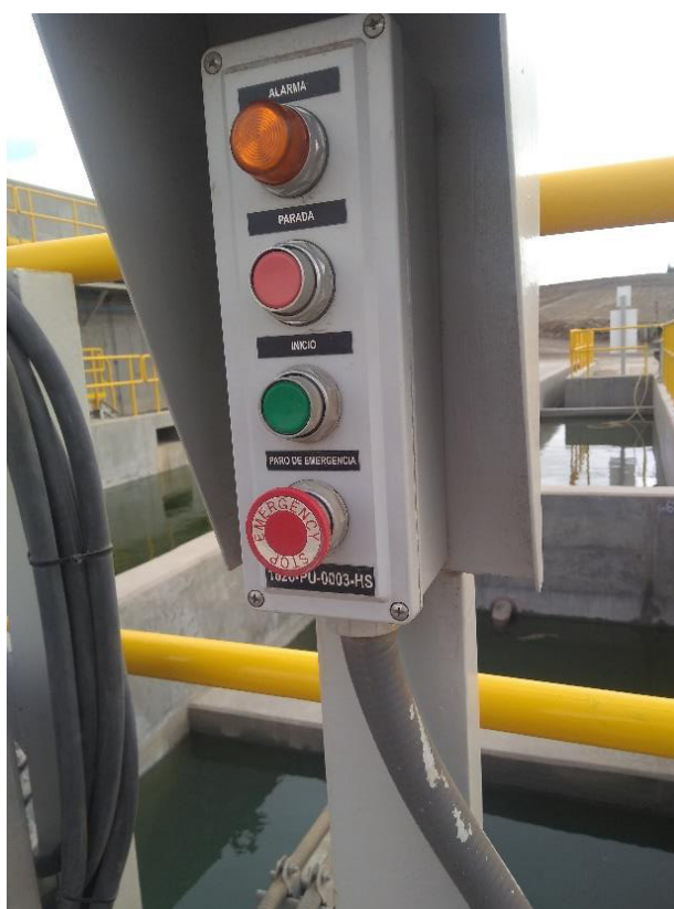
Botonera local de bomba 1628-PU-0003. Fuente: Elaboración propia
