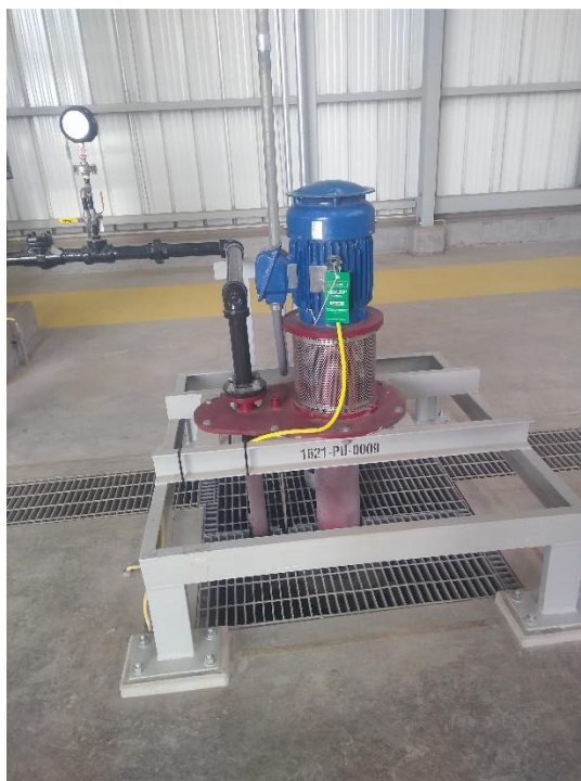
Bomba de drenaje 1621-PU-0009. Fuente: Elaboración propia
