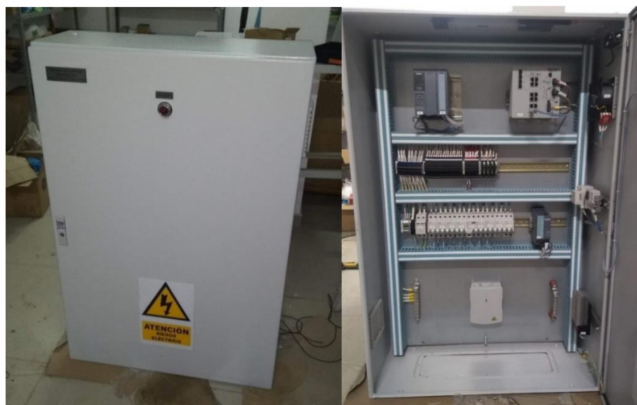
Figura 12: Fotos del tablero de control 1636-PCC-0001. Fuente: Elaboración propia.
