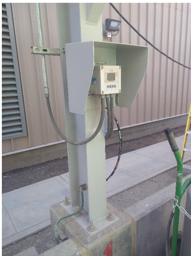
Transmisor indicador de nivel 1624-LIT-0020. Fuente: Elaboración propia
