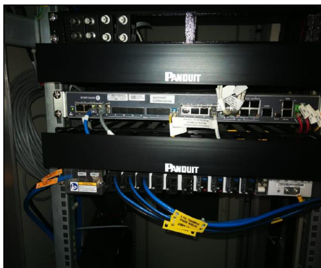
Figura 17 Vista del equipo SAR-A. Fuente: Elaboración propia
