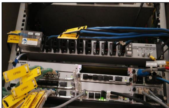
Figura 18 Vista del equipo DCDU Y BBU. Fuente: Elaboración propia
