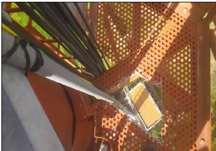
Figura 31 Recorrido del cableado (bajada). Fuente: Elaboración propia.
