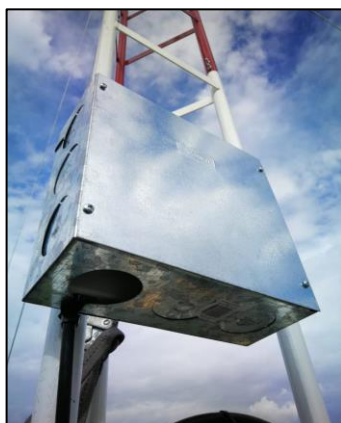
Figura 21 Caja de paso en torre ventada. Fuente: Elaboración propia.
