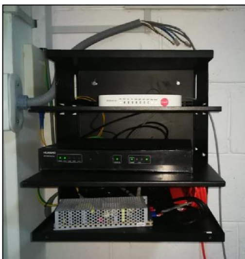
Figura 35 Vista panorámica del gabinete instalado en el local del Cliente. Fuente: Elaboración propia.
