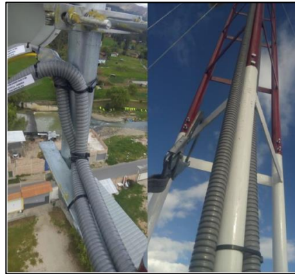
Figura 33 Recorrido del cableado desde antena. Fuente: Elaboración propia.
