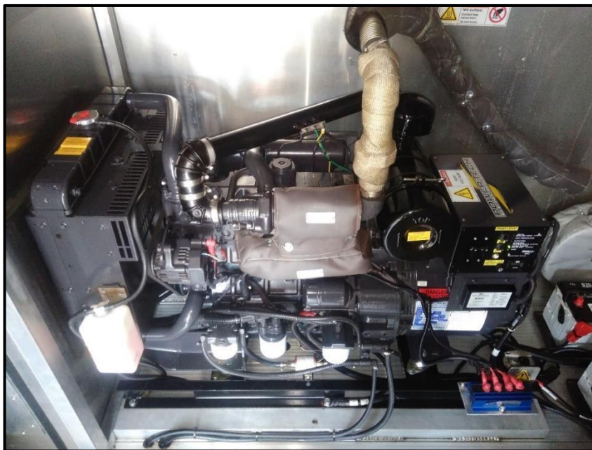
Figura 7. Generador eléctrico diésel o grupo electrógeno. Fuente: Elaboración propia.
