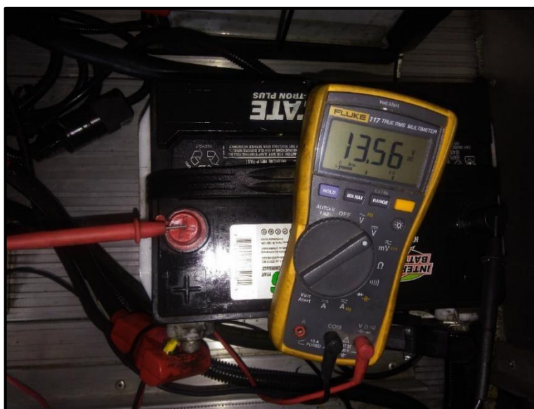
Figura 8. Medida de voltaje de batería en carga. Fuente: Elaboración propia.
