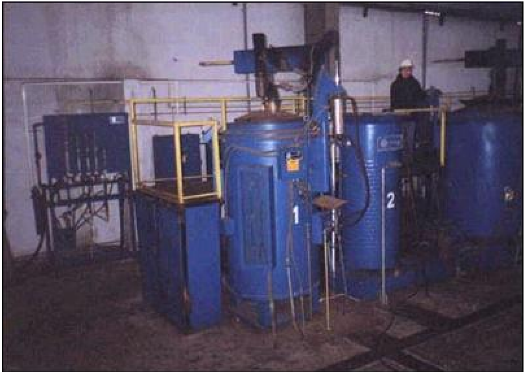
Fig. 4.3. Planta de Tratamientos Térmicos
