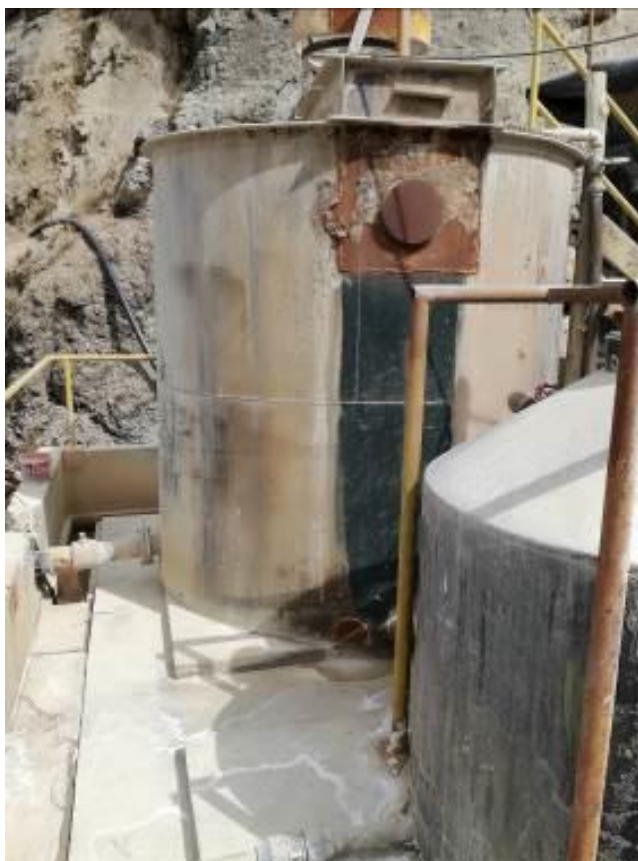
Foto N°9: Tanque inoperativo (se usará para la preparación y acondicionamiento del hidróxido de calcio)
