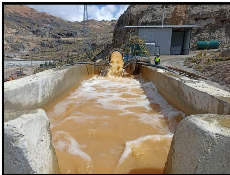
Foto N°14: desarenador N° 2 de la Planta de tratamiento de agua de mina
