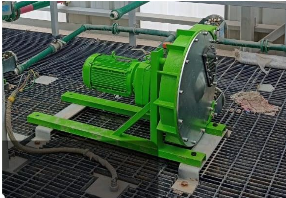
Foto N°16: bombas peristálticas para la dosificación de reactivos
