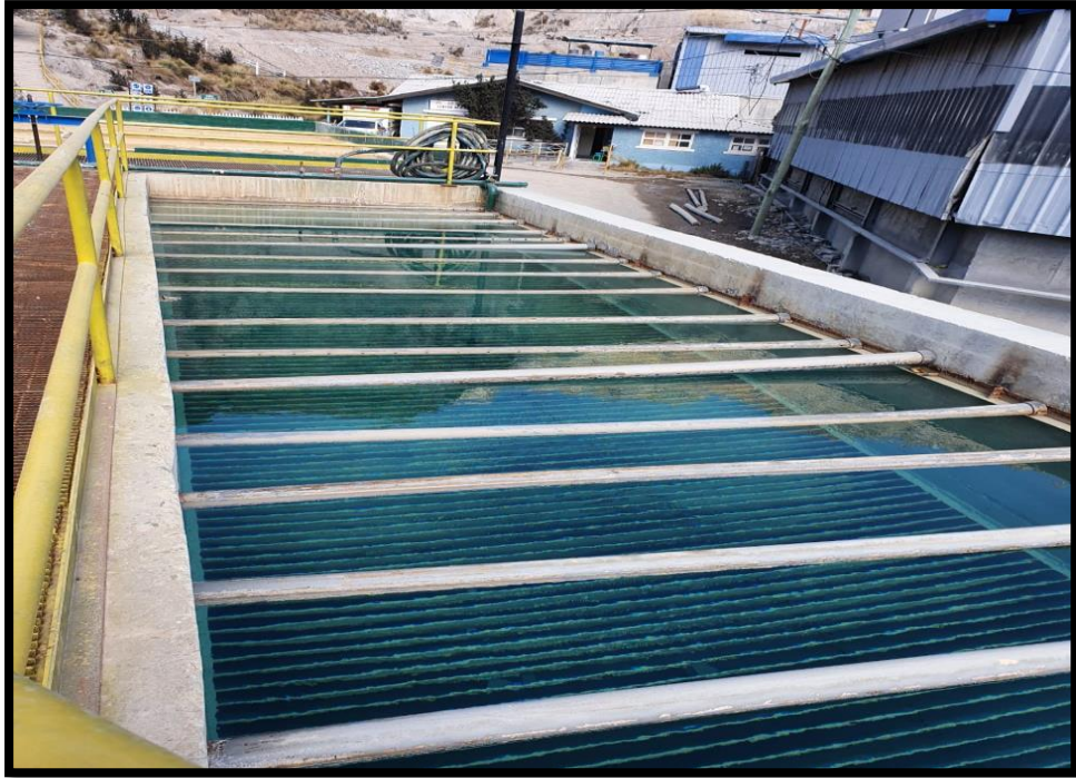
Foto N°15: clarificadores de la PTAM
