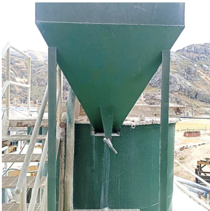
Foto N°17: Tolva de una tn para la preparación de óxido de calcio
