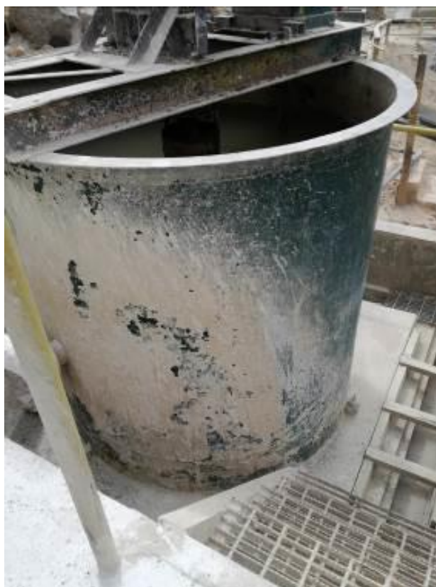
Foto N°10: Falta mantenimiento de los tanques de reactivos
