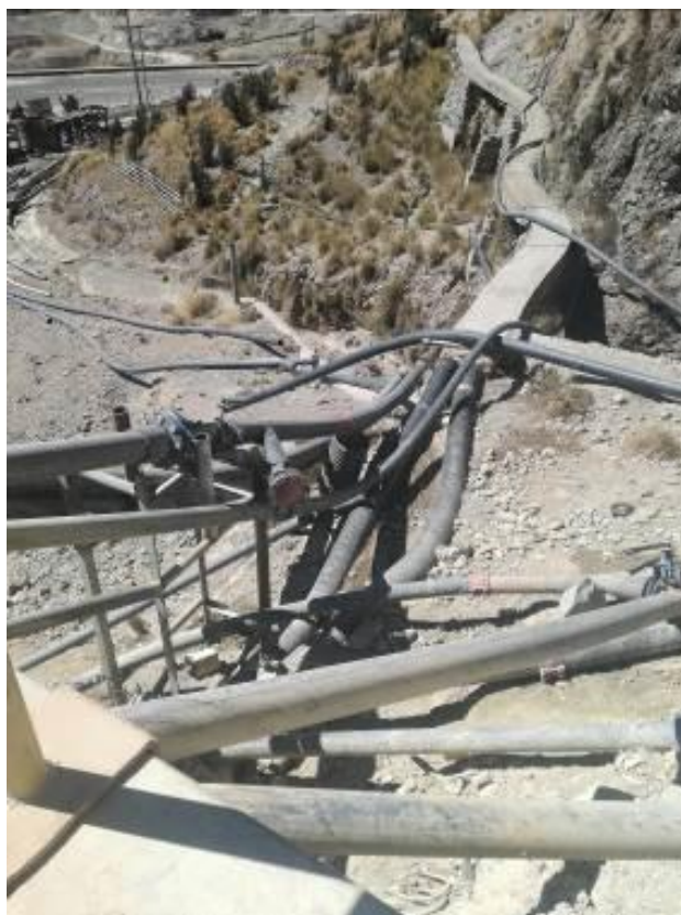
Foto N°5: Evidencia de tuberías en desuso
