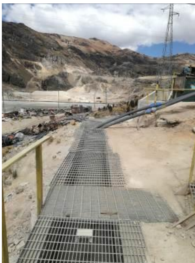
Foto N°8: Evidencia de falta de barandas en las vías de accesos
