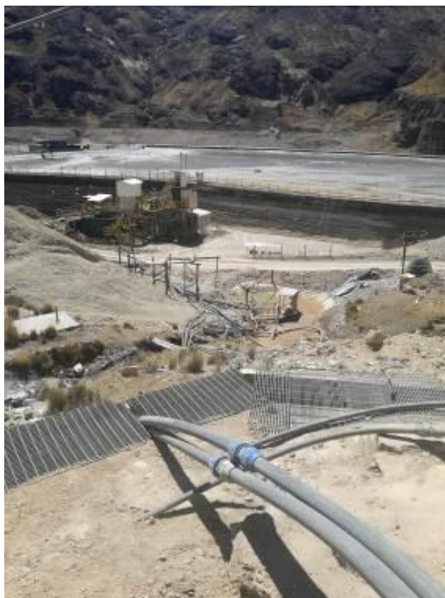
Foto N°7: Evidencia de falta de barandas en las vías de accesos
