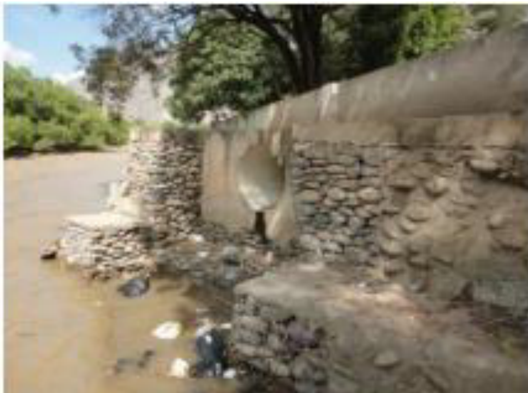
Figura 43 Vertimiento del Hospital Regional. Fuente. Dirección Regional de Salud Huánuco
