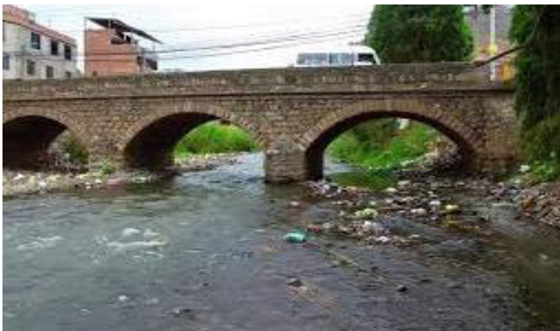
Figura 40 Residuos sólidos en el Puente Calicanto sobre el Hualaga Fuente. Google. Fotografías de Huánuco
