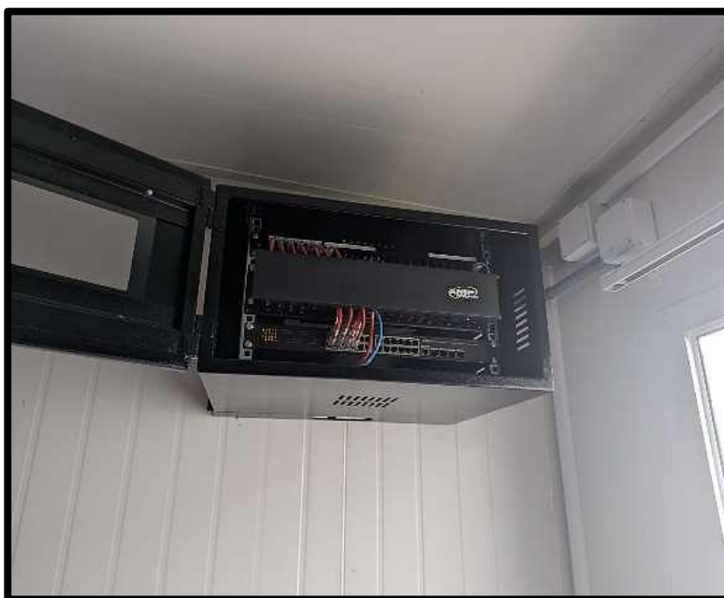
Figura 38 Gabinete y switch instalado en la posta médica Fuente. Datos obtenidos de MG Trading. Informe final CCTV MG Trading (2023).
