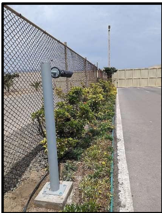
Figura 35 Cámara identificadora de placas vehiculares
