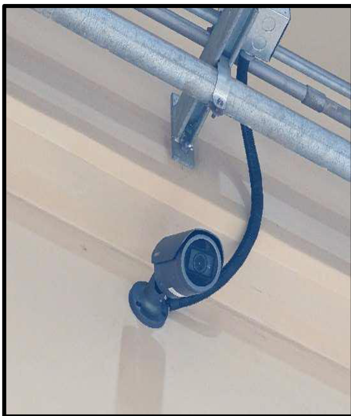
Figura 32 Cámara Bullet instalada en Taller
