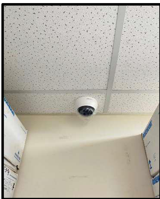
Figura 30 Cámara domo instalada en Almacén
