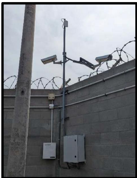
Figura 28 Instalación de cámaras en un punto perimetral
