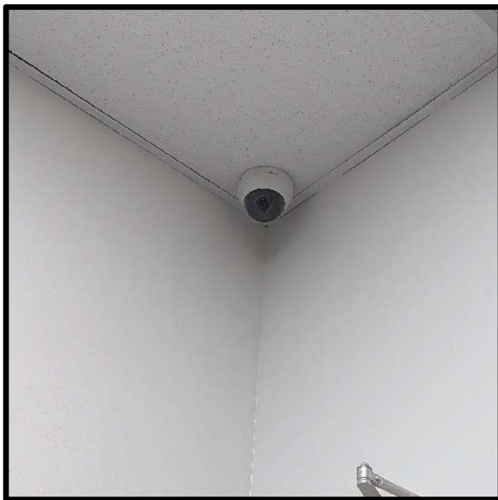
Figura 31 Cámara domo instalada en Oficinas Administrativas
