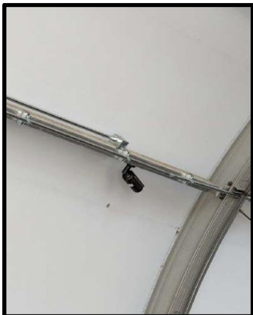
Figura 29 Cámara bullet instalada en Almacén
