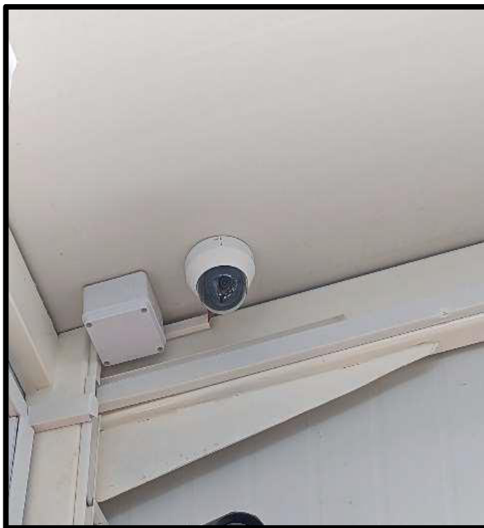
Figura 39 Cámara domo instalada en la posta médica
