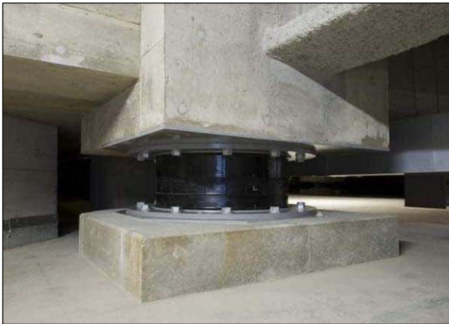
Figura 34. Amortiguador en un edificio nuevo
