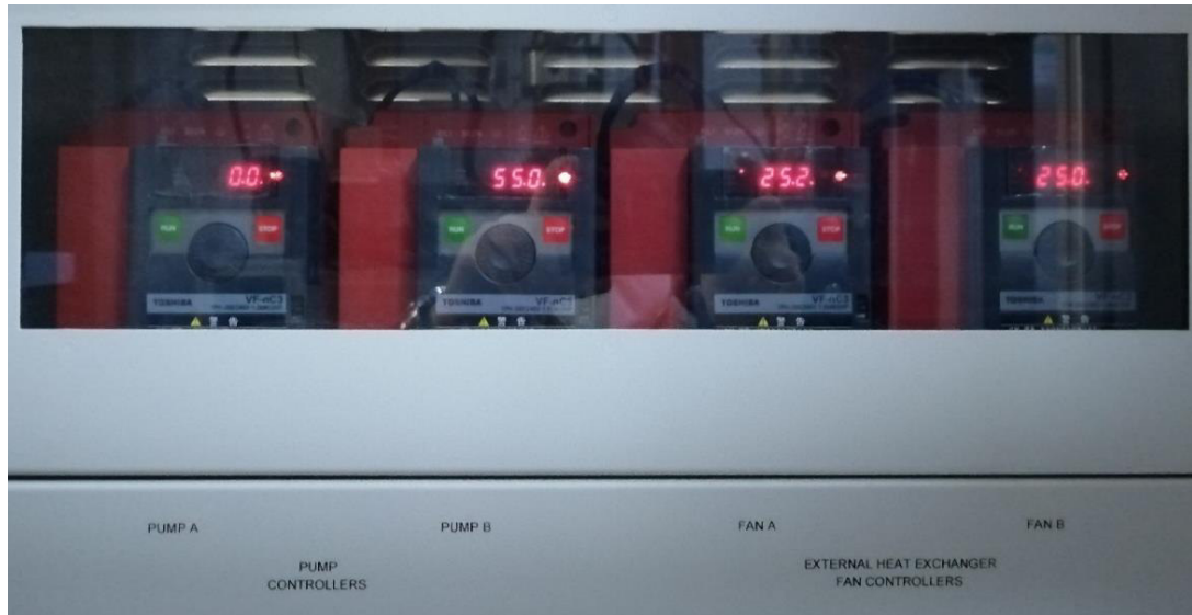
Figura 22: Lecturas del panel de control del módulo de bombas. Fuente: Elaboración propia.
