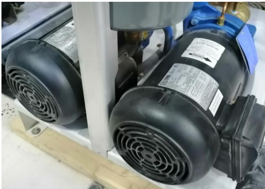
Figura 12: Bombas duales. Fuente: Elaboración propia.
