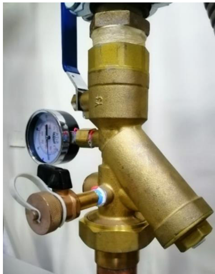
Figura 11: Filtro o strainer del sistema de refrigeración líquida. Fuente: Elaboración propia.
