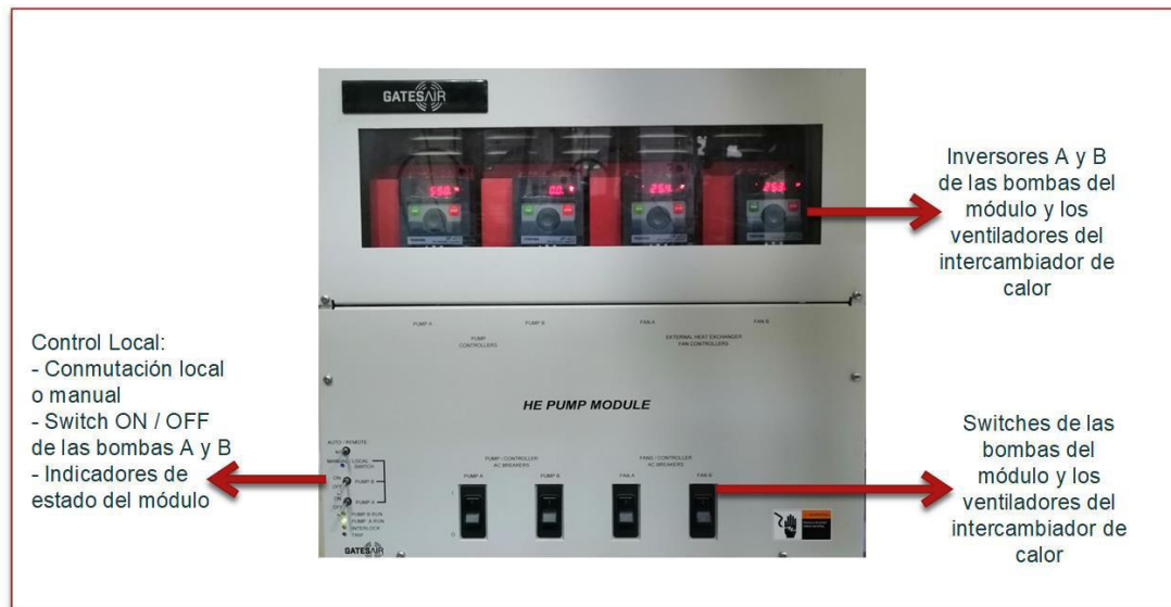
Figura 10: Panel del módulo de bombas. Fuente: Elaboración propia.
