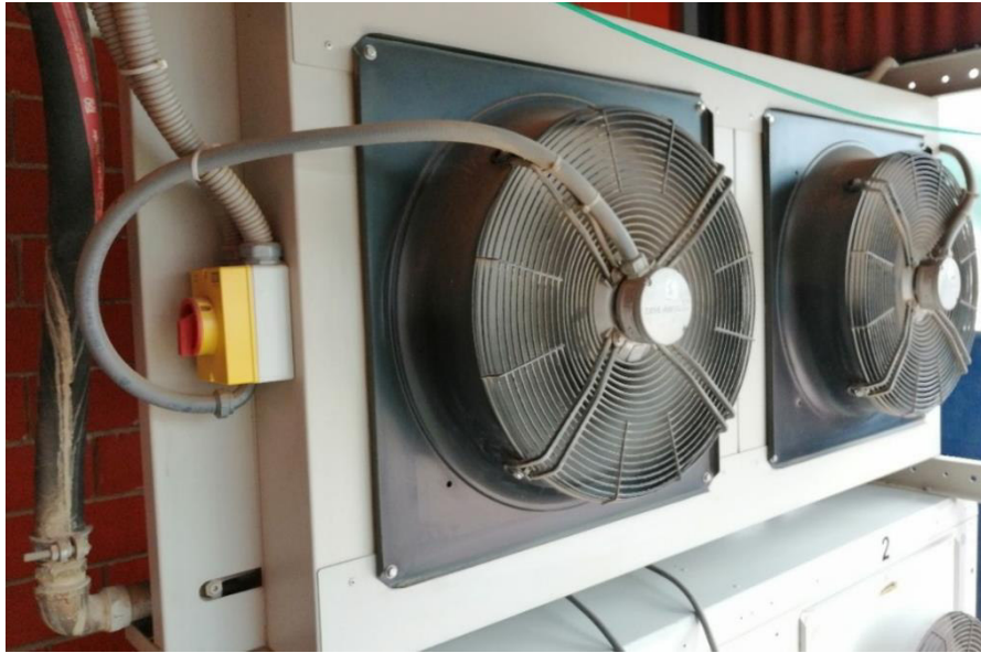
Figura 13: Intercambiador de calor. Fuente: Elaboración propia.
