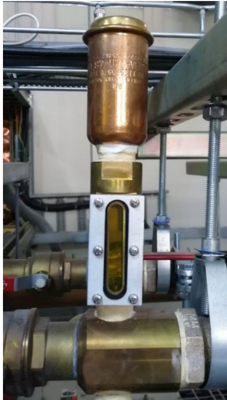
Figura 24: Visor del nivel de líquido del sistema de refrigeración. Fuente: Elaboración propia.
