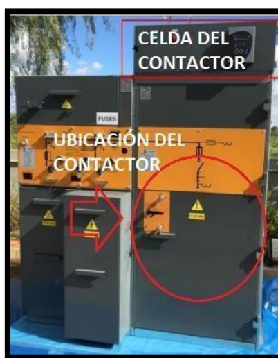
Figura 50: Ubicación De La Celda Del Contactor. Fuente: Tomado por la página web celdas ingeteam
