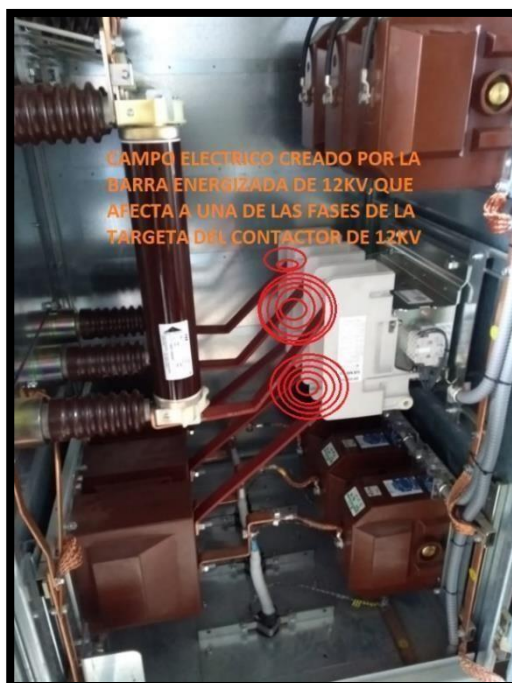
Figura 60: Barra De Cobre De 12kv Produciendo Campo Eléctrico. Fuente: Fotografía propia tomado en la central Wayra
