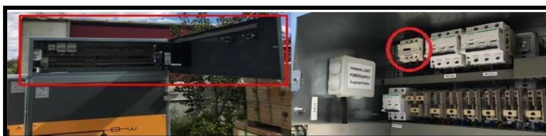
Figura 62: Ubicación Del Contactor K4 En La Celda Del Estator. Fuente: Fotografía propia tomado en la central Wayra
