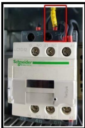
Figura 66 Conexión Del Cable "K4-3L2" . Fuente: Fotografía propia tomado en la central Wayra
