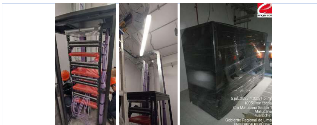
Figura 27. Cuartos de comunicación. Fuente: Propia
