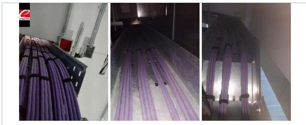
Figura 28. Distribución y peinado del cableado S/FTP. Fuente: Propia
