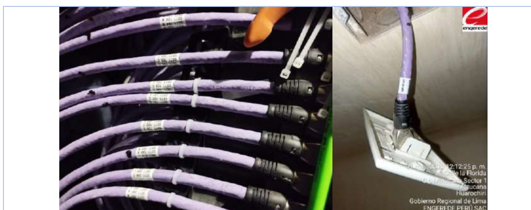
Figura 30. Rotulado de cable S/FTP Cat 7A. Fuente: Propia
