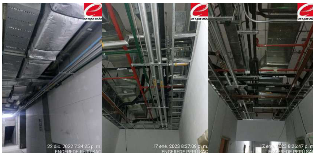
Figura 13. Espacios confinados para instalación de bandejas de comunicaciones en el Hospital San Juan de Matucana. Fuente: Propia
