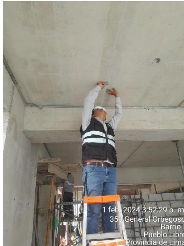
Figura 66. Inspección de ancho de fisuras Fuente: Panel fotográfico - UARM
