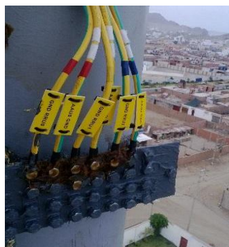
Figura 6 - Barra de tierra existente. Fuente: Foto Tomada
