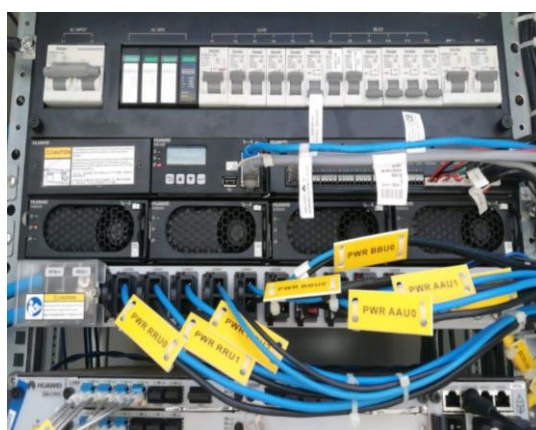
Figura 8 - DCDU existente. Fuente: Foto tomada
