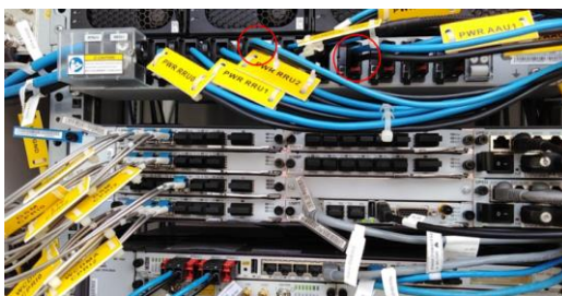
Figura 21 - Conexión del cable DC en la DCDU. Fuente: Foto Tomada
