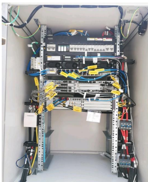
Figura 7 - Panorámica de gabinete existente. Fuente: Foto tomada
