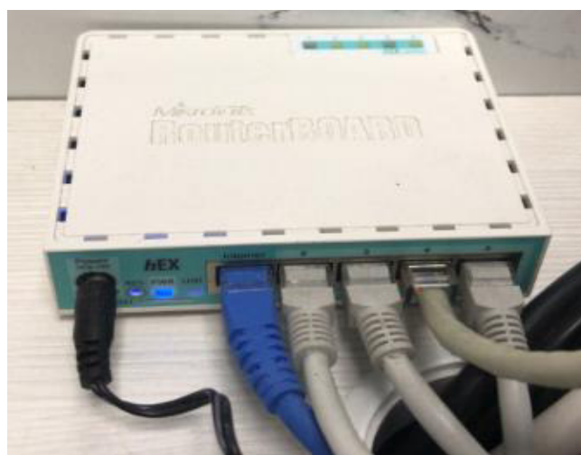
Figura 34. Switch local Mikrotik. Fuente: propia
