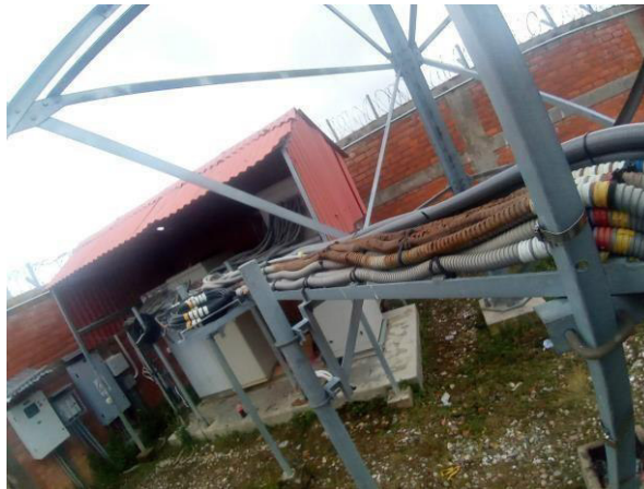
Figura 144. Recorrido Horizontal de los cables outdoor en la estación Llata. Fuente: Elaboración Propia
