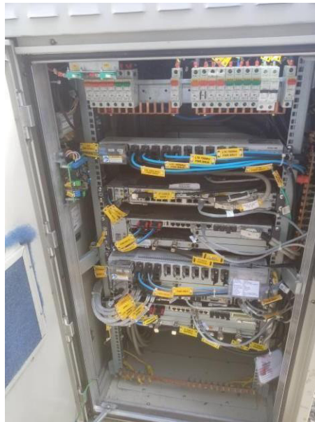
Figura 131. Vista del Gabinete en la estación Marias. Fuente: Elaboración Propia
