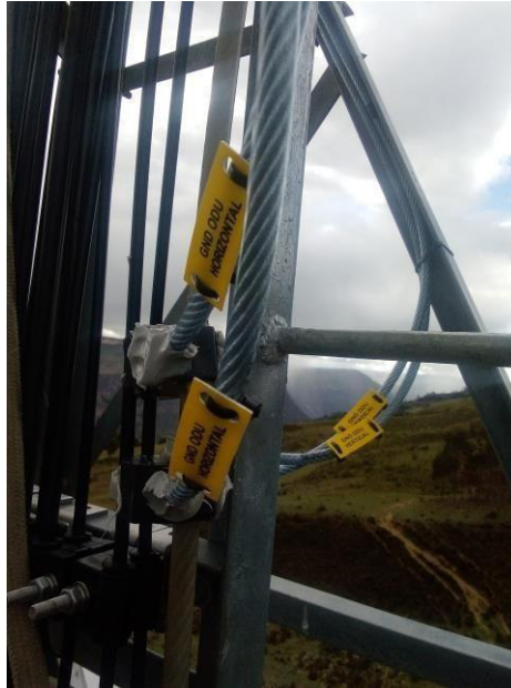
Figura 128. Aterramiento de las ODUs instaladas en la estación Marias. Fuente: Elaboración Propia
