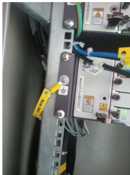
Figura 149. Aterramiento de la IDU en la estación Llata. Fuente: Elaboración Propia
