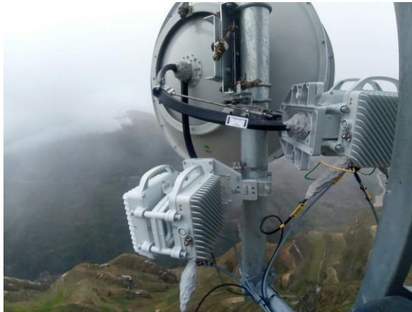
Figura 140. Vista de las ODUs instaladas en la estación Llata. Fuente: Elaboración Propia
