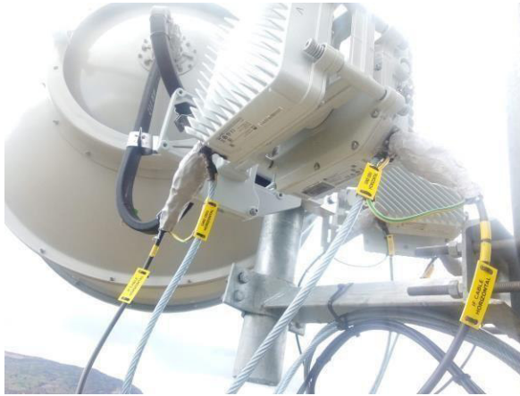
Figura 126. Vista de las ODUs instaladas en la estación Marias. Fuente: Elaboración Propia
