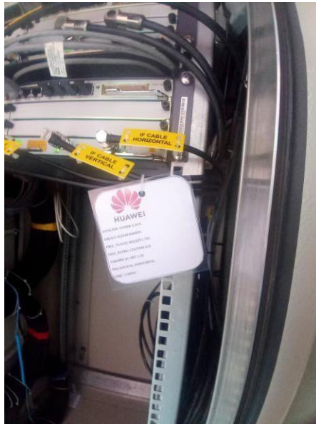
Figura 148. Etiquetado de la IDU en la estación Llata. Fuente: Elaboración Propia
