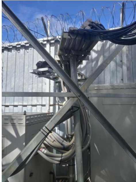
Figura 130. Recorrido horizontal de los cableados outdoor en la estación Marias. Fuente: Elaboración Propia
