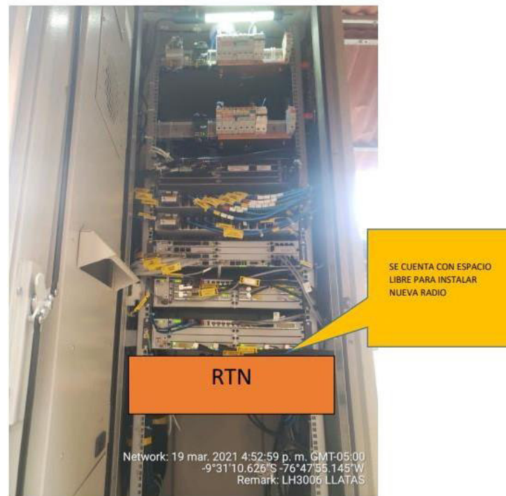
Figura 103. Visión general del rack en la estación Llata. Fuente: Elaboración propia
