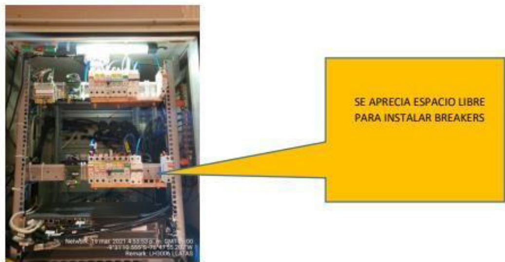
Figura 104. Visión general del rack en la estación Llata. Fuente: Elaboración propia
