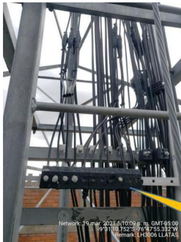
Figura 106. Vista del sistema de aterramiento en la estación Llata. Fuente: Elaboración propia
