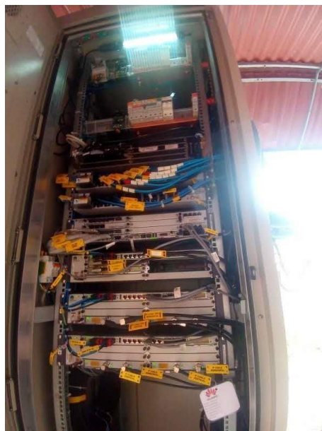
Figura 145. Vista panorámica del gabinete instalado en la estación Llata. Fuente: Elaboración Propia
