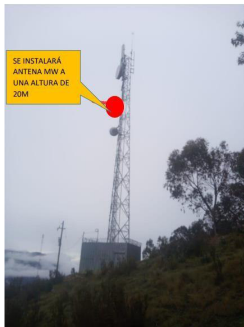
Figura 17. Torre auto soportada ubicada en la estación Marías. Fuente: Elaboración Propia
