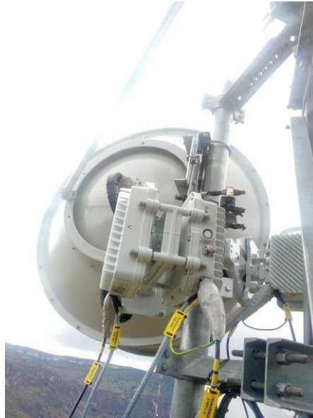
Figura 123. Antena dual-polarized Huawei instalada de la estación Marias. Fuente: Elaboración Propia
