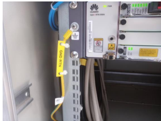
Figura 135. Aterramiento de la IDU en la estación Marias. Fuente: Elaboración Propia
