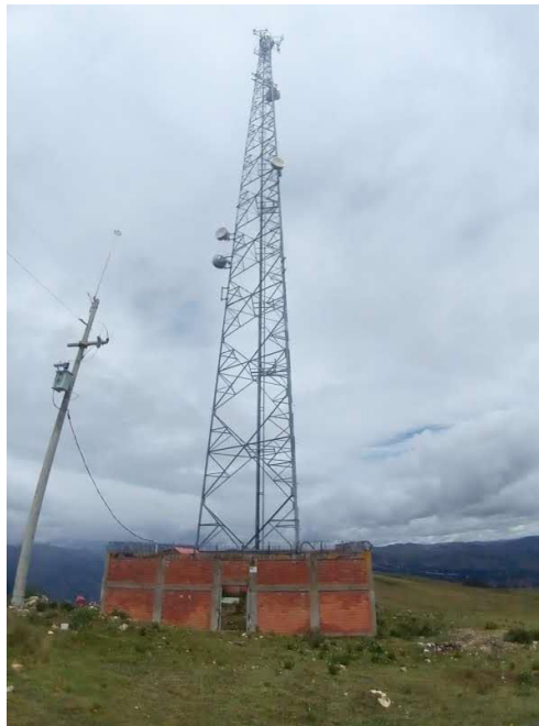
Figura 136. Vista panorámica de la estación Llata. Fuente: Elaboración Propia
