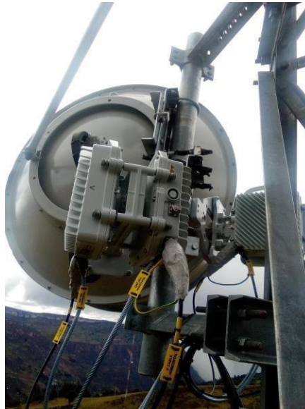
Figura 124. Vista del mástil, coupler, ODU instaladas de la estación Marias. Fuente: Elaboración Propia
