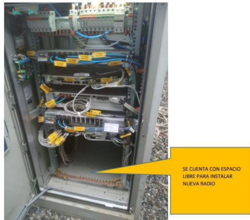
Figura 101. Visión general del rack en la estación Marias. Fuente: Elaboración propia
