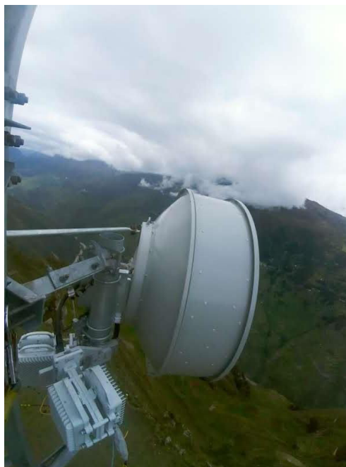
Figura 137. Vista panorámica de la estación Llata. Fuente: Elaboración Propia
