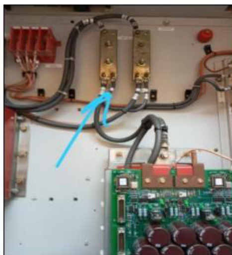
Figura N°4: Barra de los polos positivo y negativo del campo del generador
