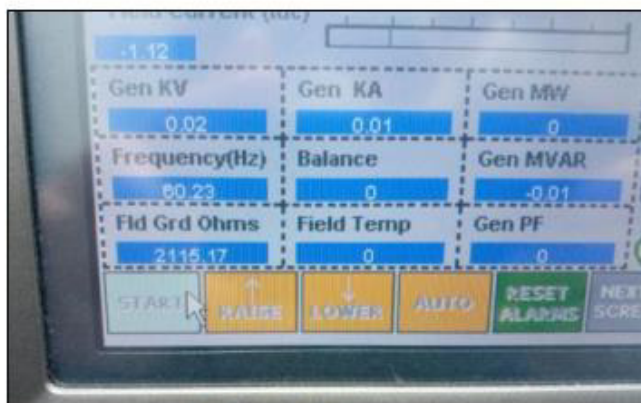
Figura N°9: Valor de resistencia inicial del conjunto de resistencias en serie para la prueba de Trip del FGD visualizada en el HMI del gabinete
