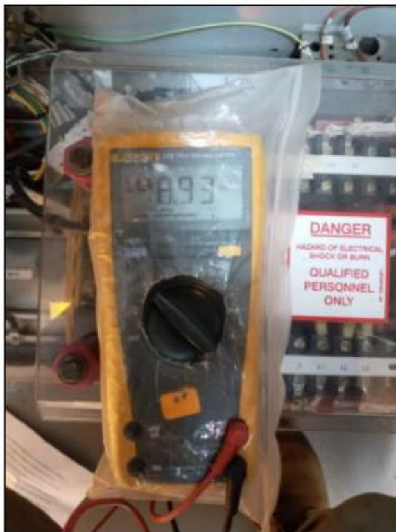
Figura N°2: Voltaje medido entre el terminal E1 y tierra
