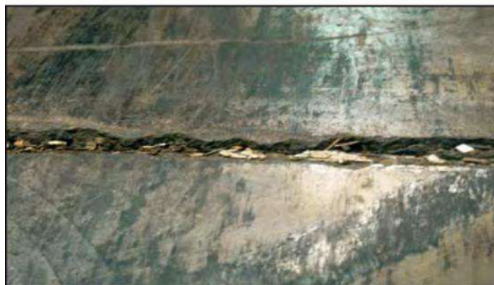
Figura 9. Junta deteriorada en un piso de concreto
