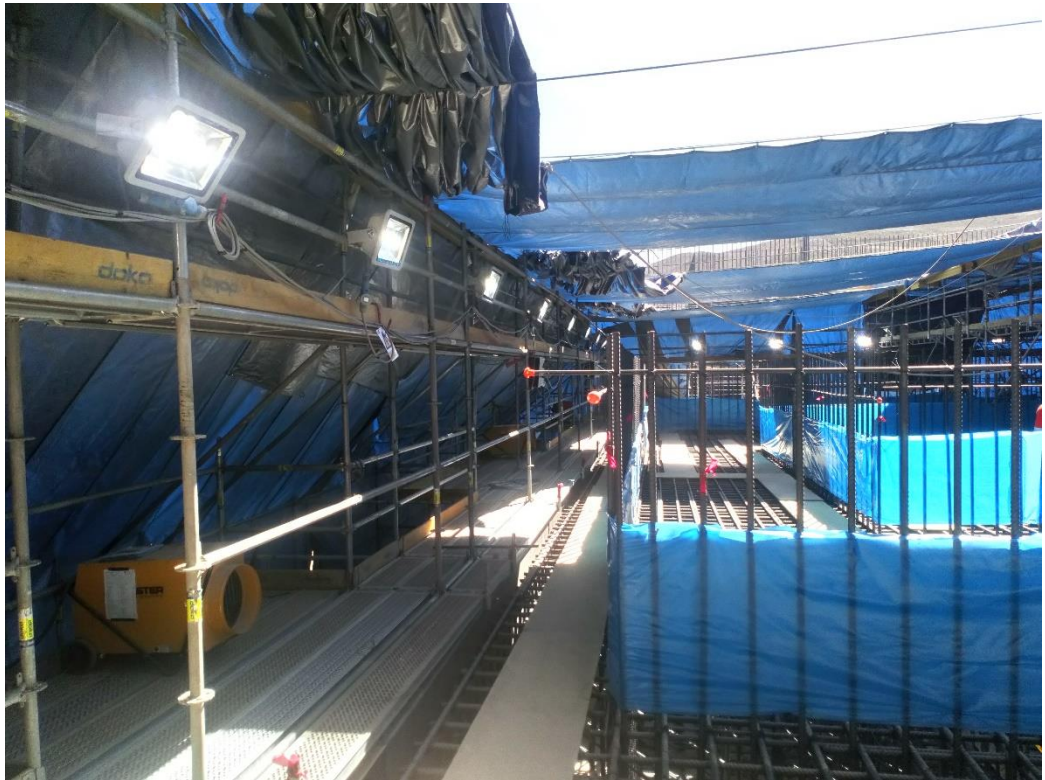
Figura 42. Detalle de espacio para turbocalentadores en estructura de microclima.
