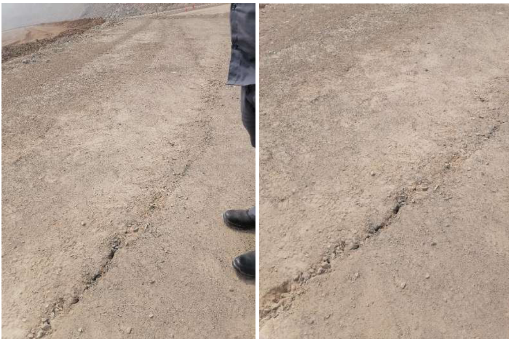
Foto N° 4: Vista de las grietas formadas en la superficie de cobertura por presencia de solución de jarosita en el depósito N° 3 en la refinería de zinc Cajamarquilla. Por lo cual la extracción de la solución de jarosita es primordial para realizar el cierre del depósito, para evitar asentamientos y licuefacciones en el futuro.
