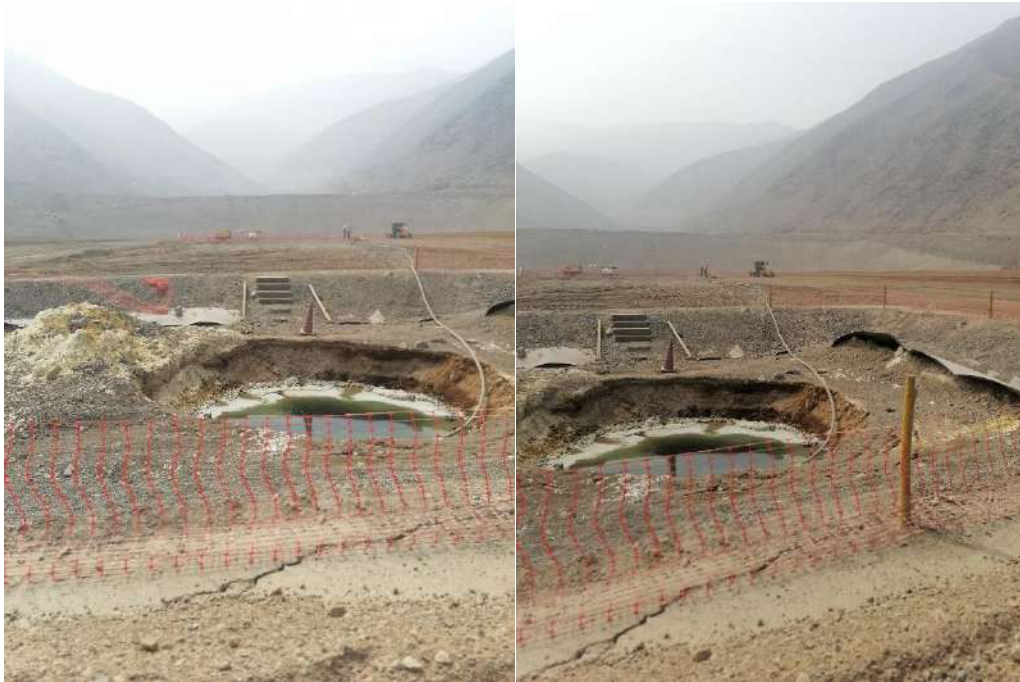
Foto N° 3: Vista de solución de jarosita color verdoso en el depósito N° 3 en la refinería de zinc Cajamarquilla.
