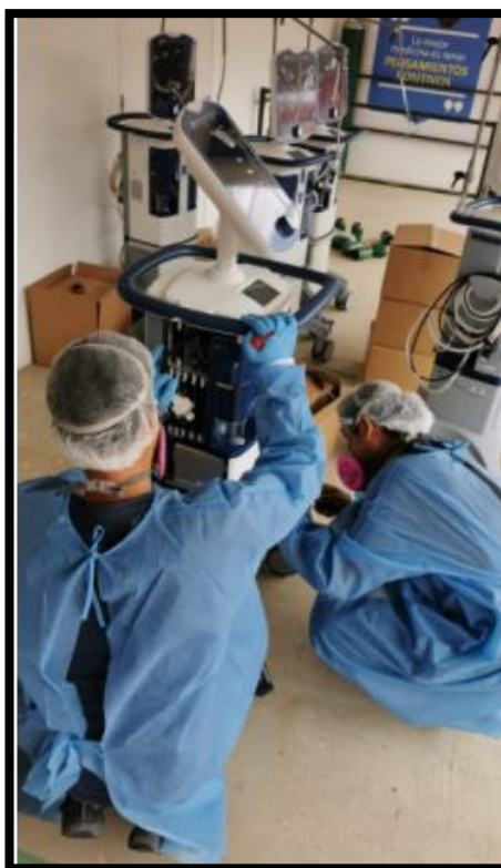
Figura 11: Conexión de Ventiladores. Fuente: Propia Trabajo de Campo
