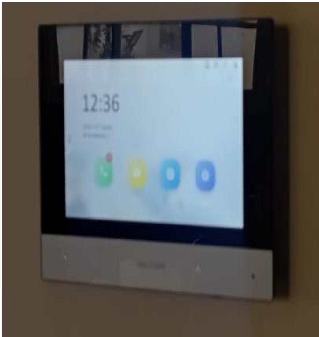
Figura 40 Monitor WIFI Instalado, dentro de uno de los departamentos. Fuente: Elaboración propia.
