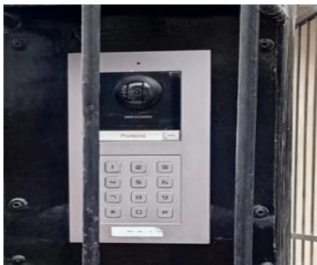
Figura 39 Frente de calle del edificio, instalado en la reja con Housing HikVision. Fuente: Elaboración propia.
