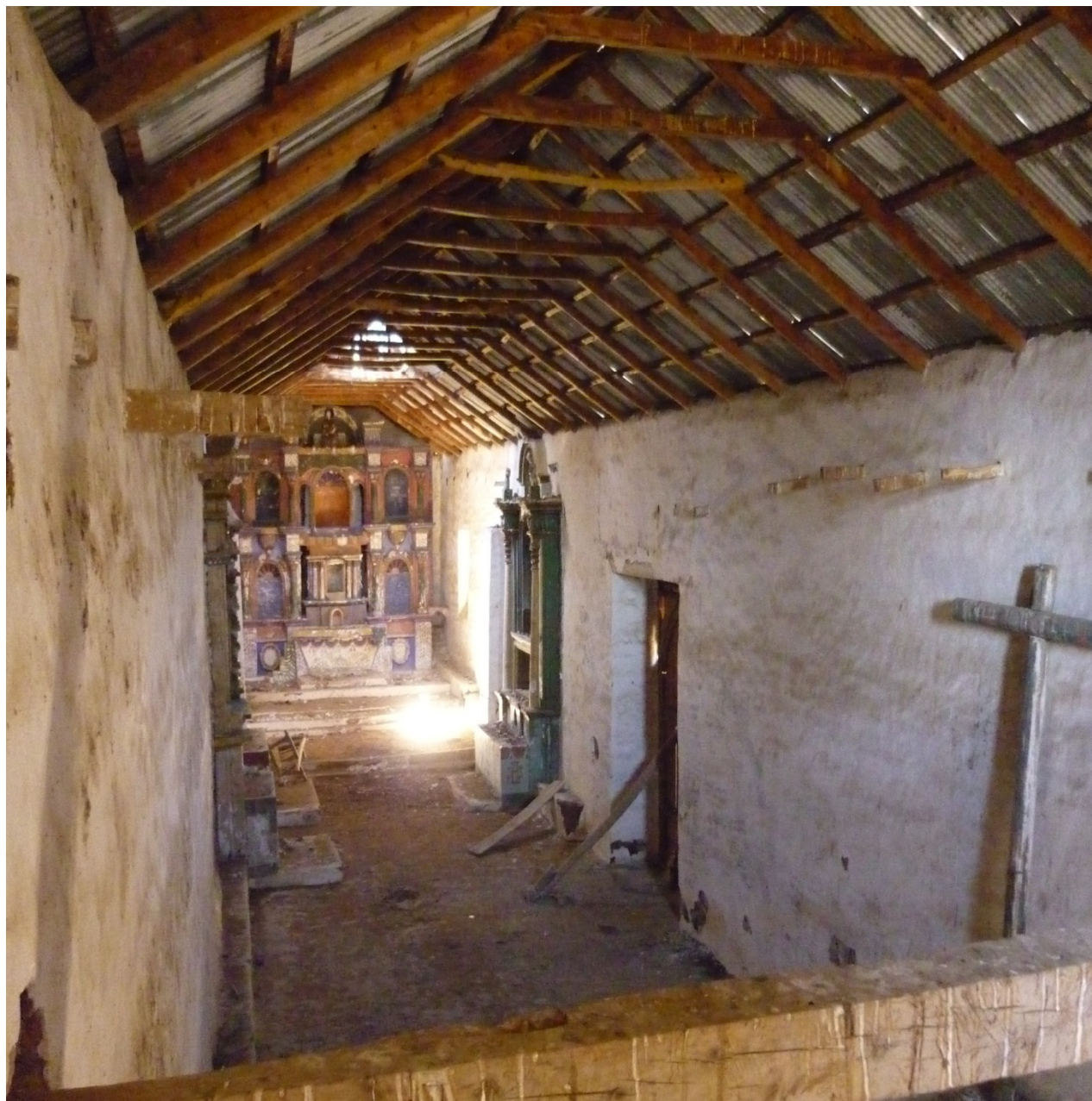
Figura 12: Parte interior de la antigua iglesia de Santiago de Maray, en total abandono. Elaboración Nelsi Mallqui (2017).
