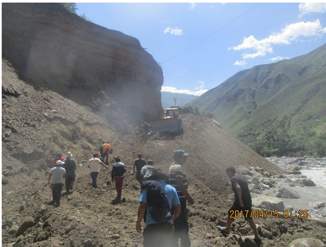
Figura 26: Estado de la carretera que une a los distintos pueblos de las provincias alto andinas de la provincia de Huaura a raíz de las últimas inundaciones. Bardales (2017) .
