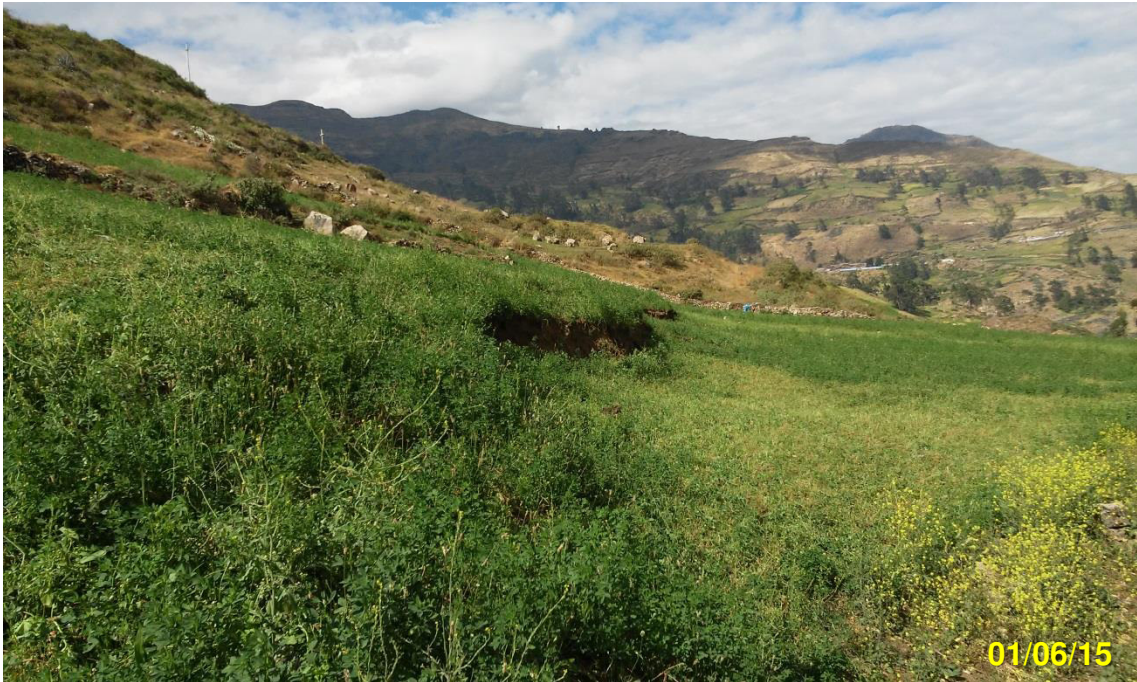
Foto N° 1. Vista en perfil de un agrietamiento y desplazamiento en la ladera superior
