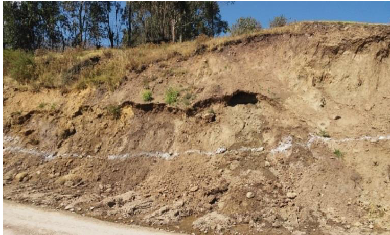
Foto N° 4.5. Filtraciones de agua Km 105+520
