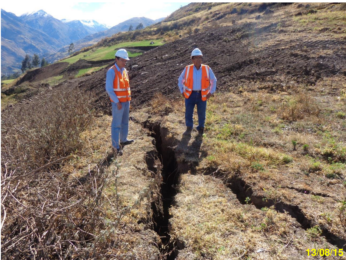
Foto N° 8. Grietas tensionales producidas en la corona del talud (>30 cm de abertura)
