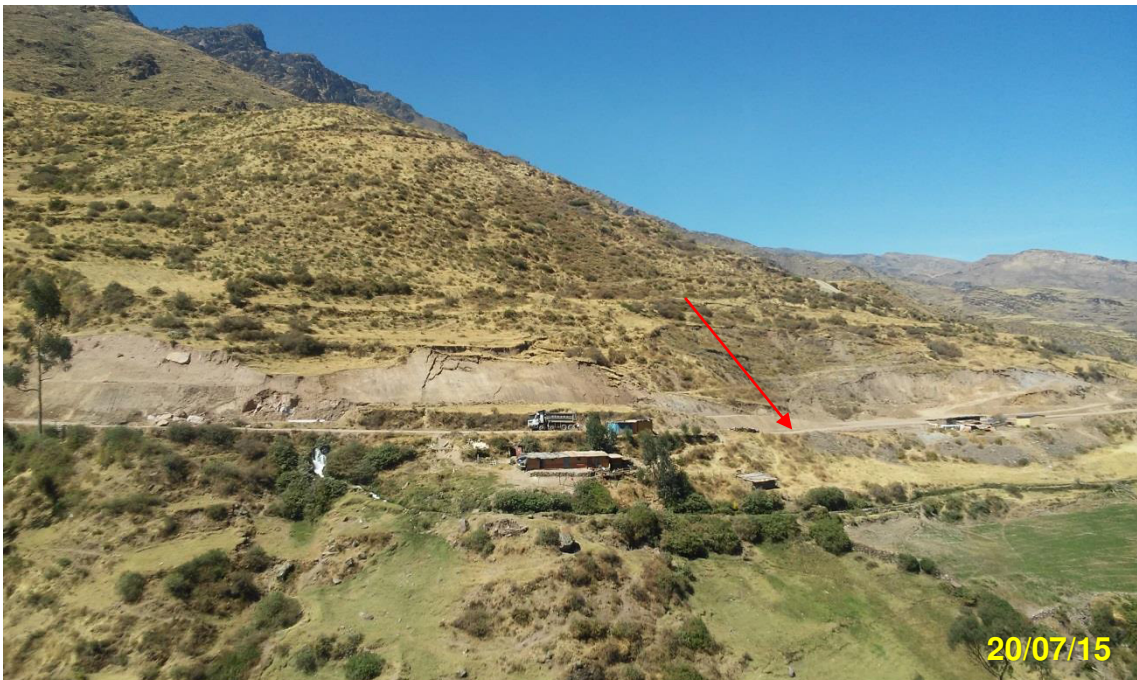
Foto N° 18. Vista panorámica del deslizamiento, véase el asentamiento de la plataforma.
