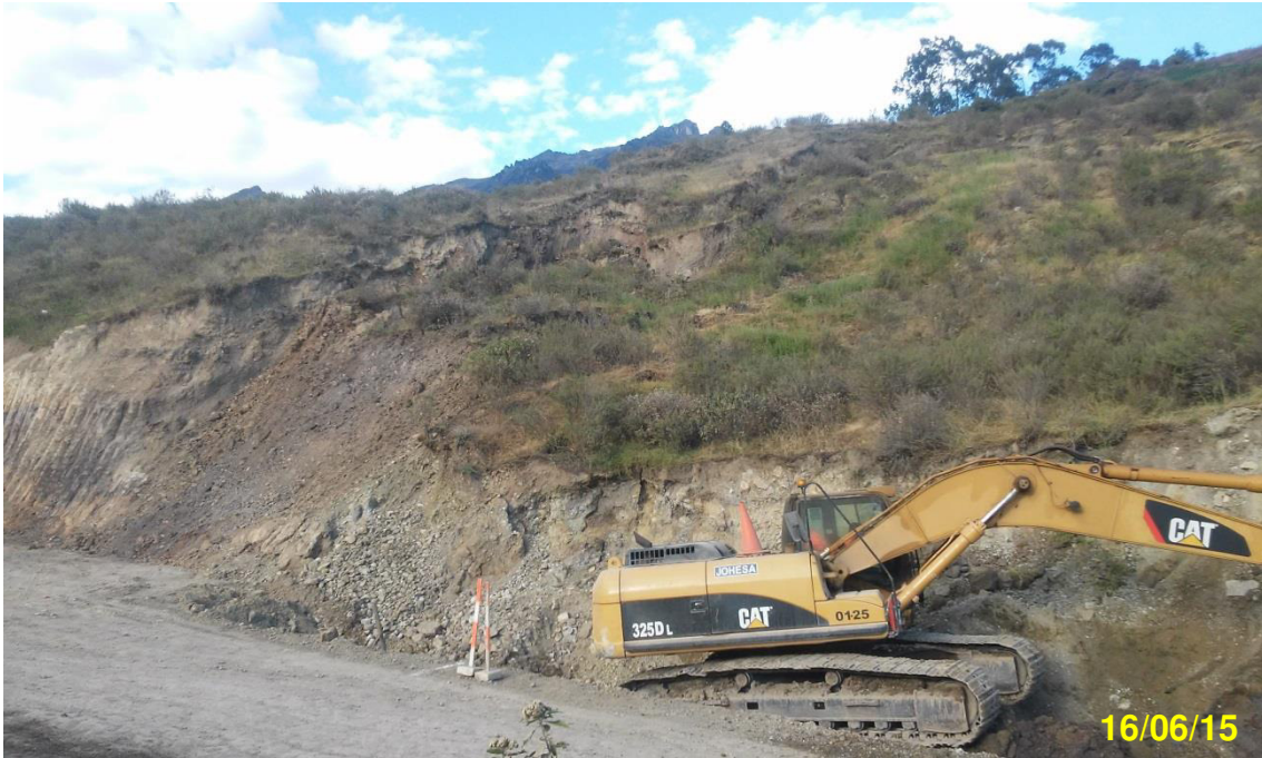
Foto N° 9. Inicio de cortes en el talud. Nótese la ocurrencia de deslizamientos.
