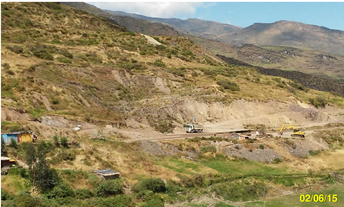
Foto N° 16. Vista panorámica de la zona, nótese los planos de deslizamiento temporalmente estabilizados en el talud.
