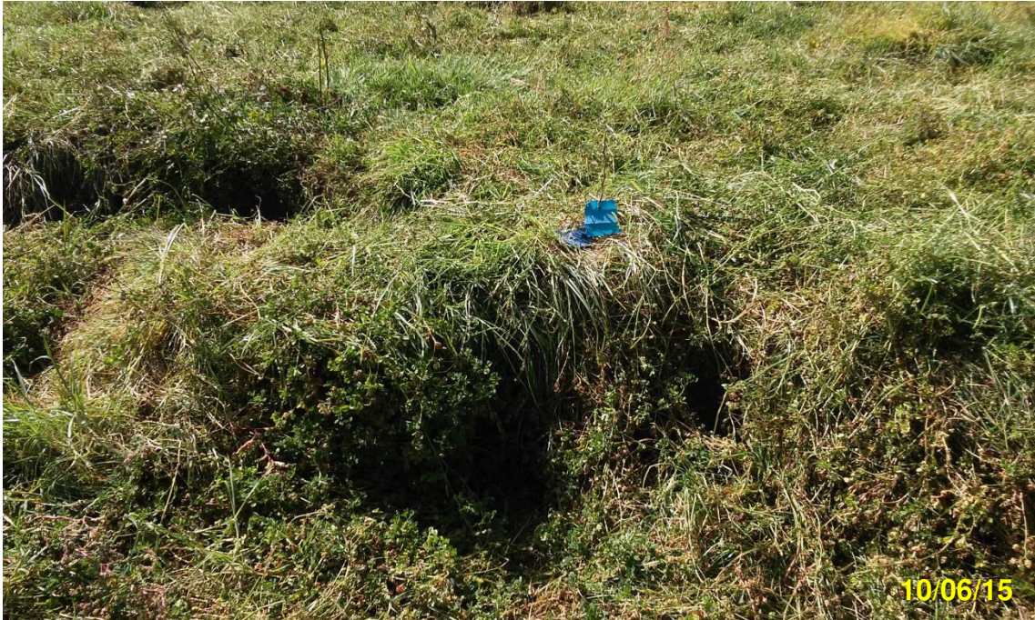
Foto N° 17. Agrietamientos en la ladera superior.
