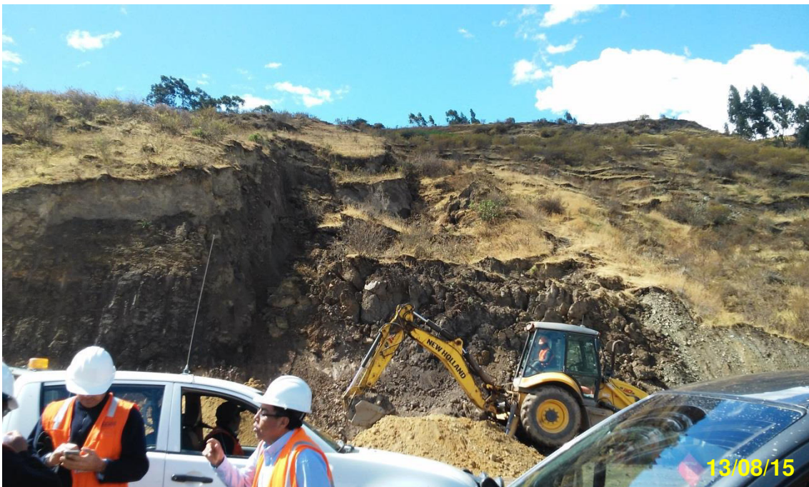
Foto N° 14. Reptación de Suelos. Filtraciones de agua hacia las paredes del talud.
