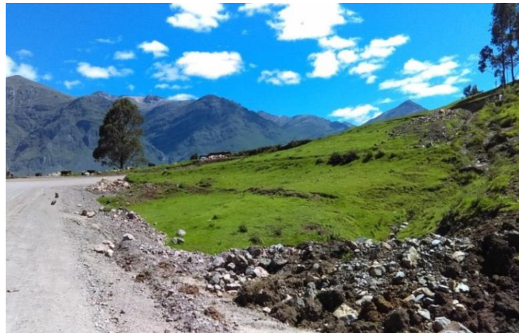
Foto N° 4.4. Reptación de suelos Km 108+450
