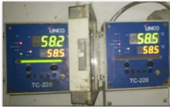
Figura 18. Controlador de Temperatura
