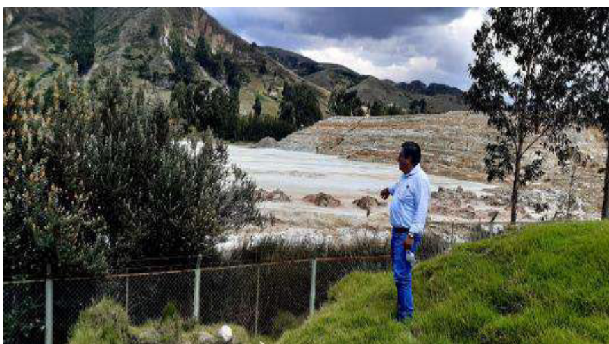
Figura 5.11 Parte inferior del relave Ticapampa.
