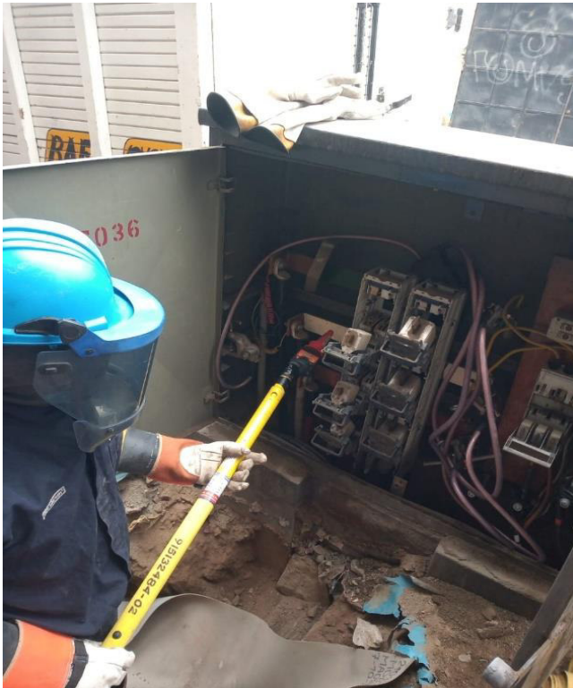
Figura 8. Operario realiza el revelado de un tablero eléctrico de BT, usando el revelador y pértiga
