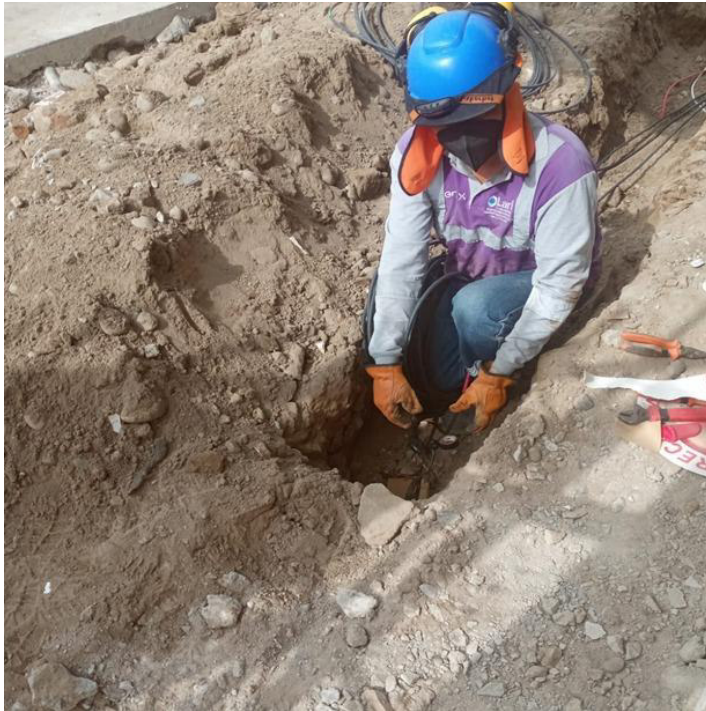
Figura 4. Trabajador realizando empalme de BT, sin careta y capucha ignífuga, guantes y mantas dieléctricas
