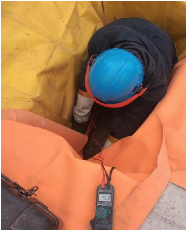
Figura 10. Operario realiza prueba de descarte de tensión, usando el EPP dieléctrico y zona de trabajado aislado con mantas dieléctricas
