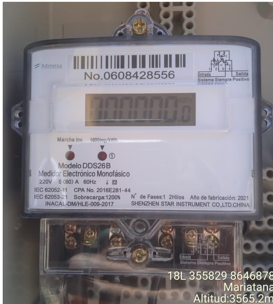
Figura 11. Tipo de medidor utilizado para el reemplazo - Fuente: Propia
