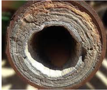
Figura 1. Tubería afectada por los precipitados de calcio y magnesio, debido al paso de aguas de alta dureza.
