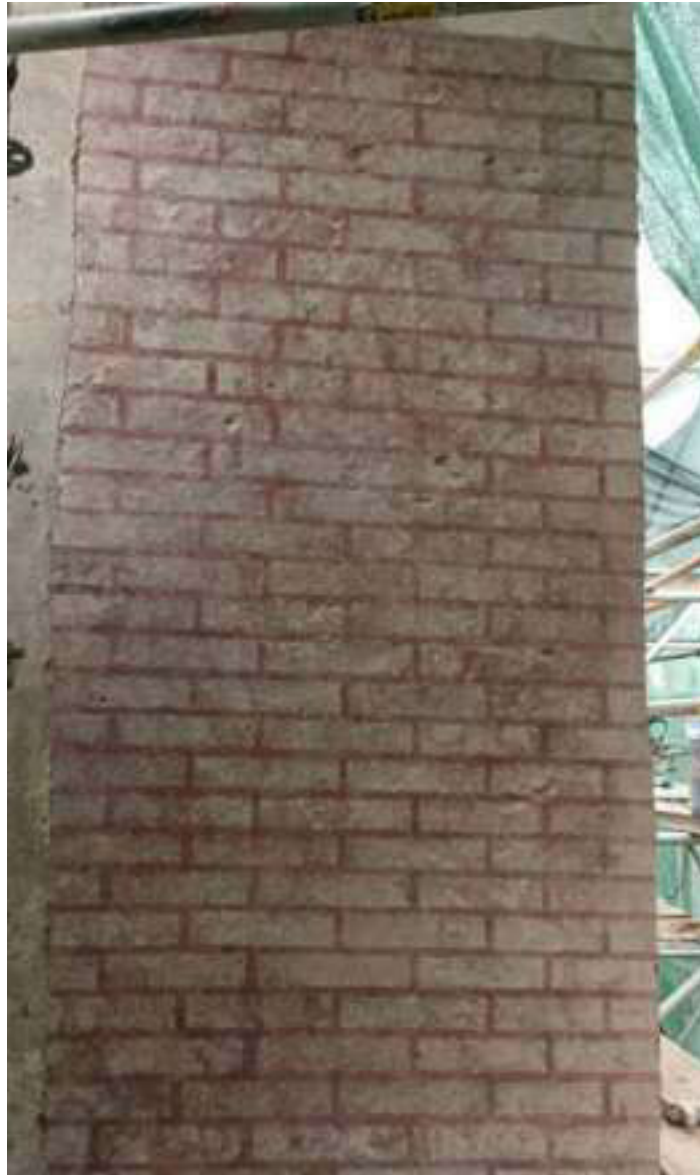
Imagen 06: levantamiento de no conformidad
