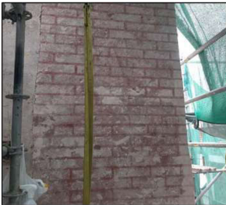
Imagen N°04: No conformidad N°31 (NC-31) en S02-SS04
