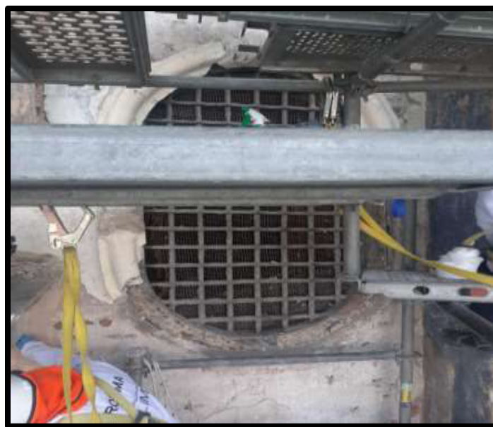
Fotografía N°06: Estado inicial de rejas metálicas de Sector 01
