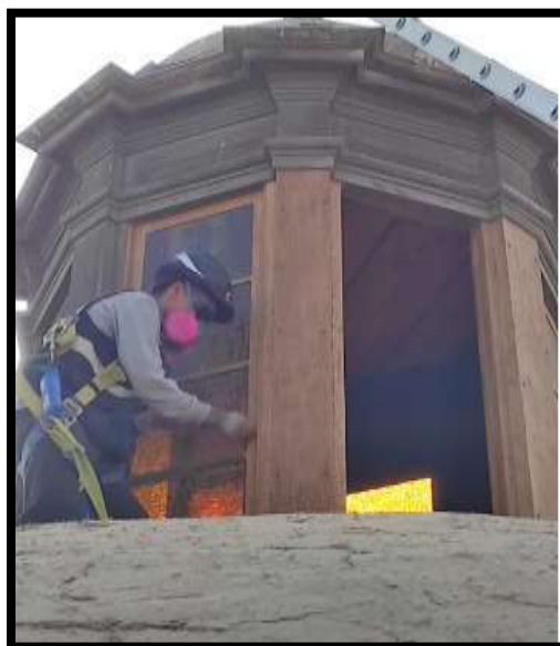
Fotografía N°32: Decapado de pintura incompatible en elementos ornamentales de madera en Sector 04
