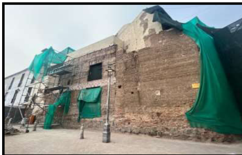
Fotografía N°24: Liberación de revoques de barro en Sector 03
