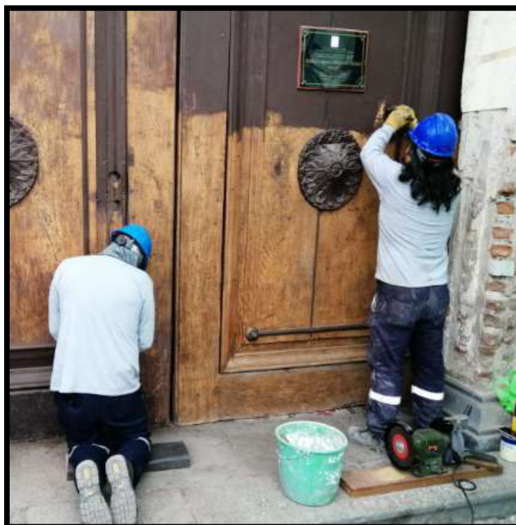
Fotografía N°30: Decapado de capas incompatibles de pintura en elementos ornamentales de madera en Sector 01
