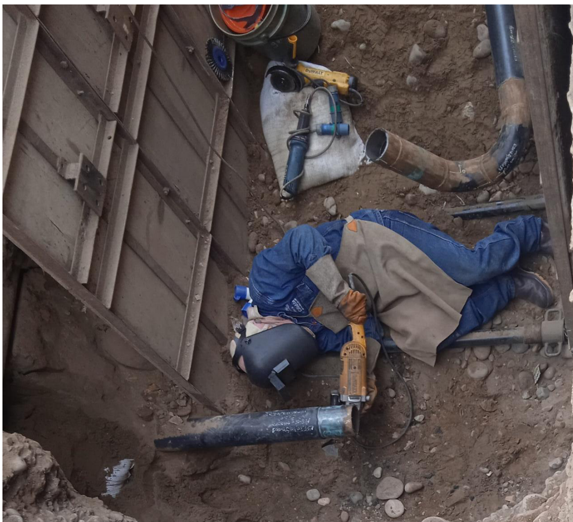
(Figura.1.2), tubería soterrada de acero de gas natural, Fuente registro propio
