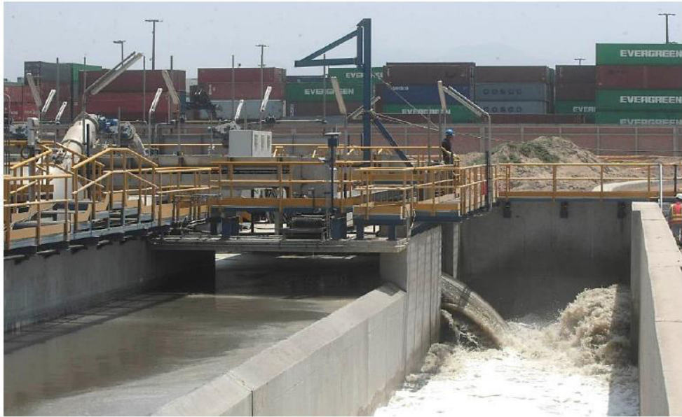
Anexo 12. Planta de tratamiento de aguas residuales Taboada, Lima, Perú (Fuente: Suárez, 2017)
