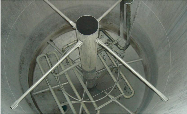
Inyectores de H_2O_2 y serpentín de calentamiento -Tanque Pachuca
