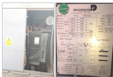
Figura 19. Transformador T2 y su placa de características Fuente propia
