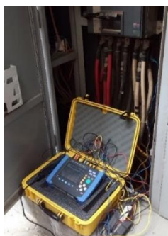
Figura 22. Conexión de analizador de redes Hioki en tablero TG-2 Fuente propia
