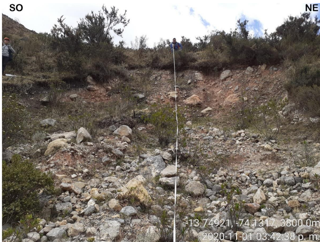
Figura 53 GD06 Deslizamiento por flujo
