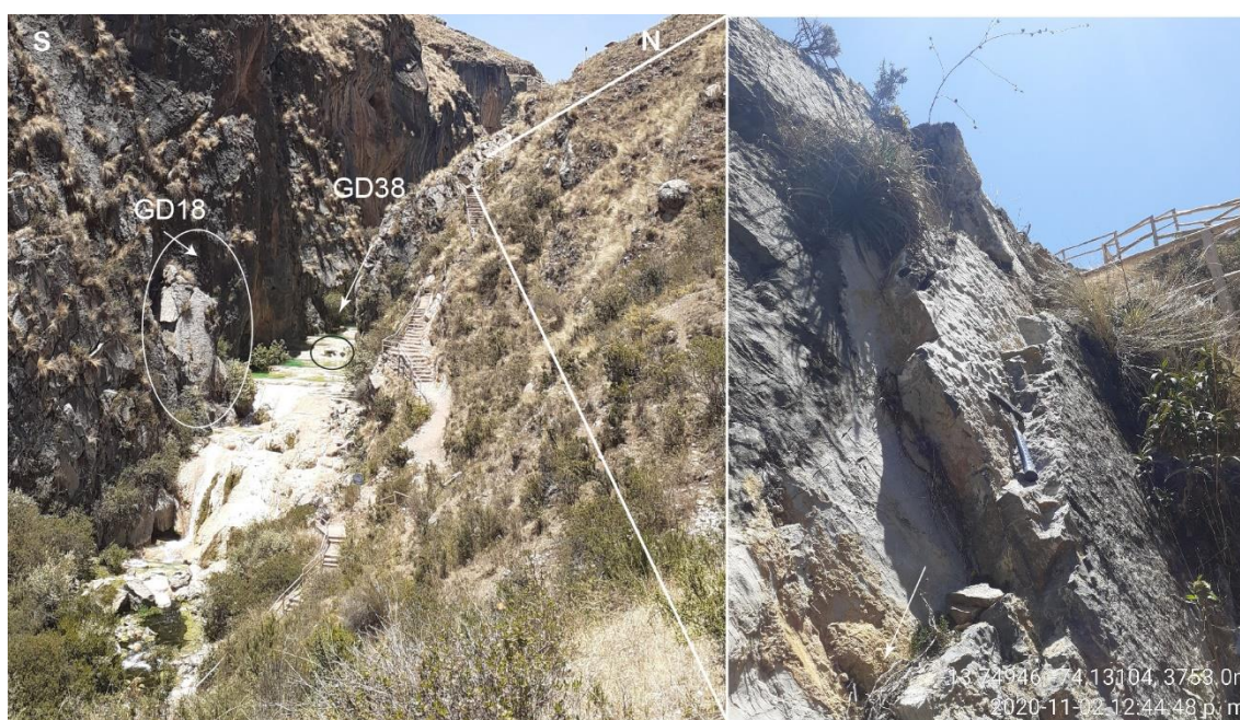
Figura 61 GD18 y GD38 Caída de roca
