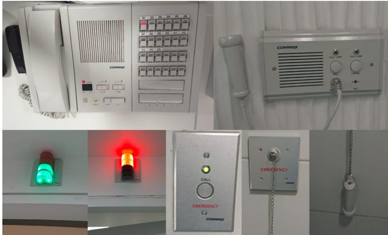
Figura 66: Pruebas de funcionamiento en el sistema de llamado de enfermeras Commax implementado. Fuente: Actividad laboral.
