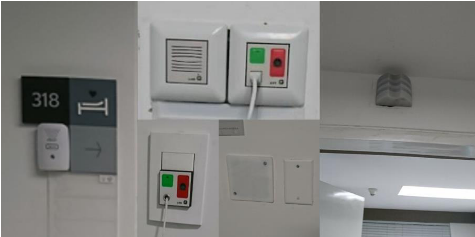
Figura 64: Componentes instalados del sistema de llamado de enfermeras Optimus – Habitación 318 Fuente: Actividad laboral.
