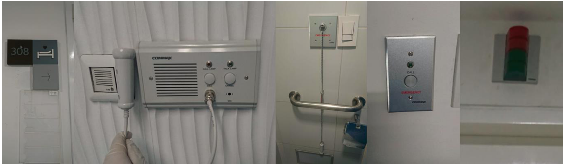
Figura 60: Componentes instalados del sistema de llamado de enfermeras Commax– Habitación 308 Fuente: Actividad laboral.
