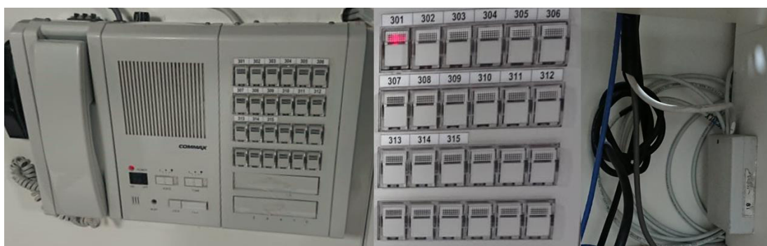
Figura 29: Central de Control de Llamadas Commax / Modelo: JNS-24. Fuente: Actividad laboral.
