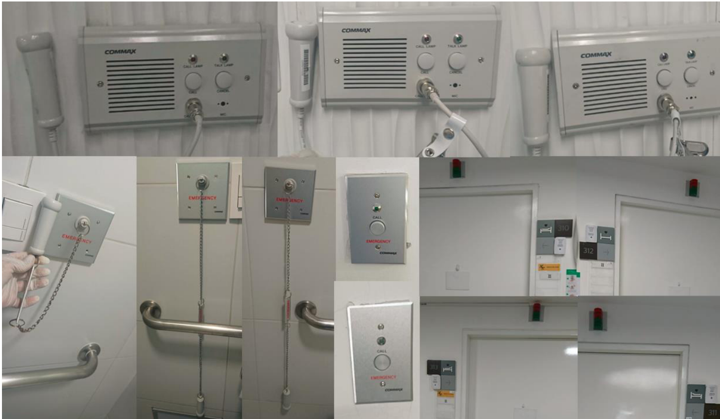
Figura 70: Componentes instalados del sistema de llamado de enfermeras Commax – Hospitalización COVID-19. Fuente: Actividad laboral.
