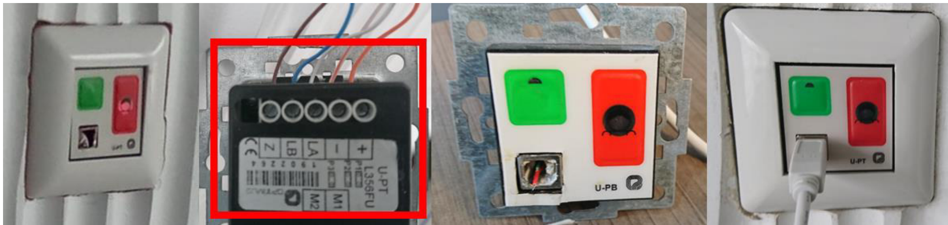
Figura 27: Reemplazo de módulo de cabecera U-PT. Fuente: Actividad laboral.
