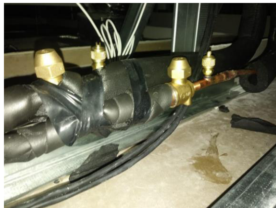
figura 26. Tubería de cobre
