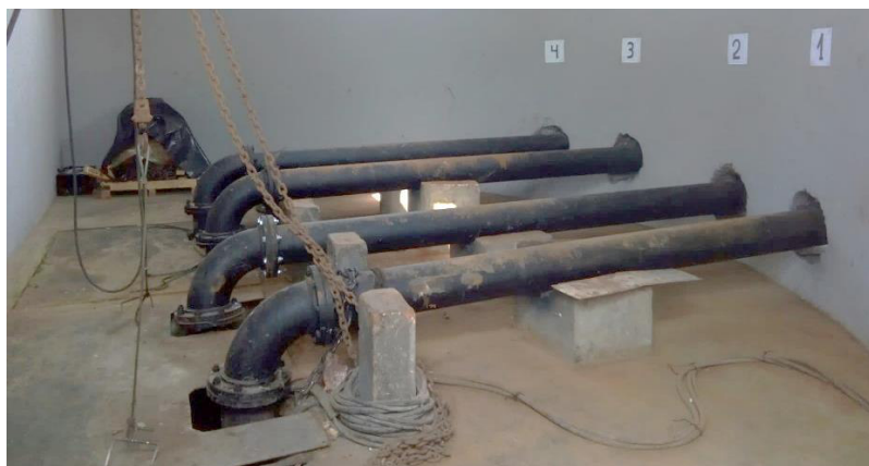
Tubería de descarga CD-65
