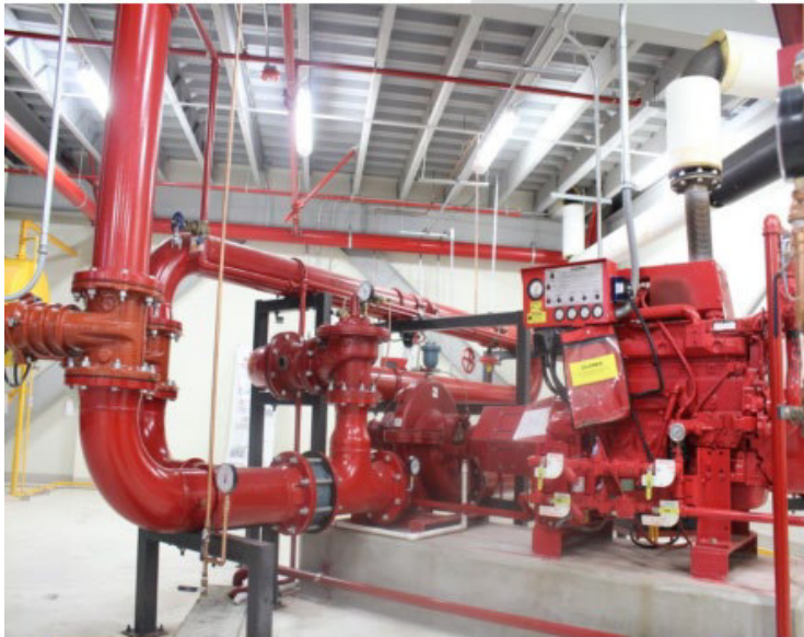
Figura 6. Sistema de Bombeo
