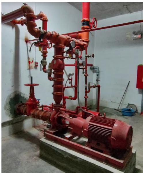
Figura 20. Sistema de bombeo ACI existente
