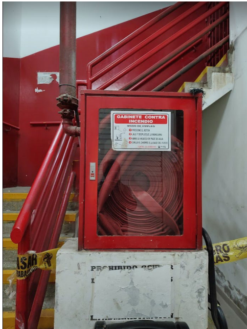
Figura 16. Gabinete clase 2 instalado en el mercado 3 de febrero
