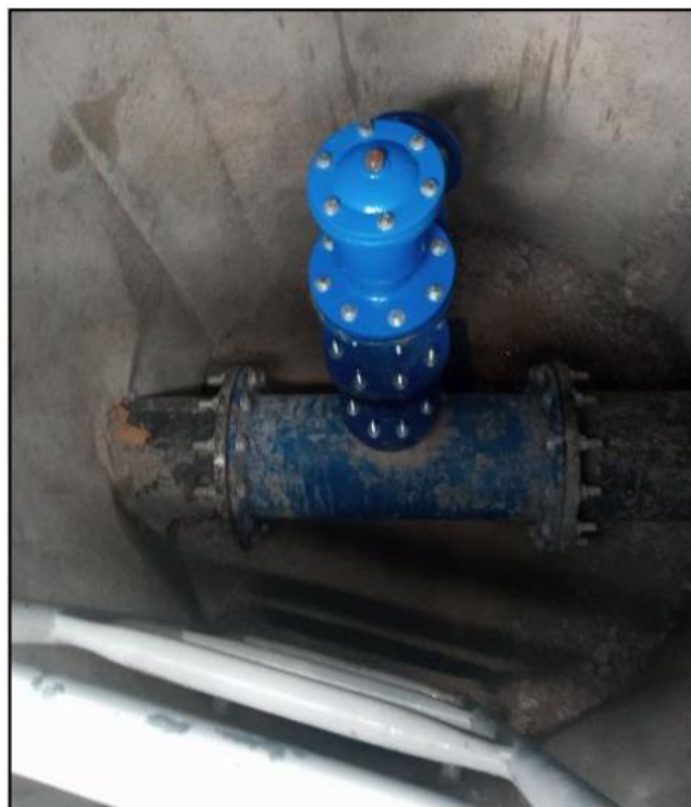
Foto N°06: Se muestra la vista de la Válvula de Aire instalada.
