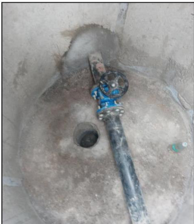
Foto N°05: Se muestra la vista de la Válvula de Purga instalada.
