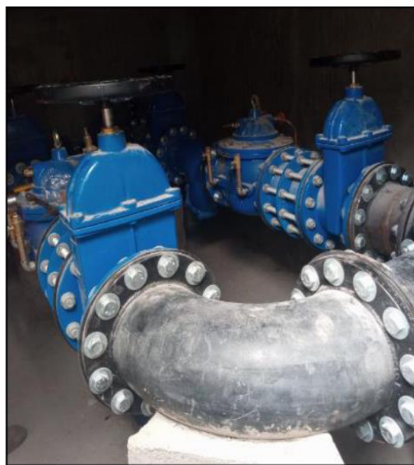
Foto N°04: Vista de la válvula reductora de presión.
