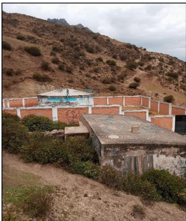
Foto N°08: Se muestra la vista del Reservorio N°02.
