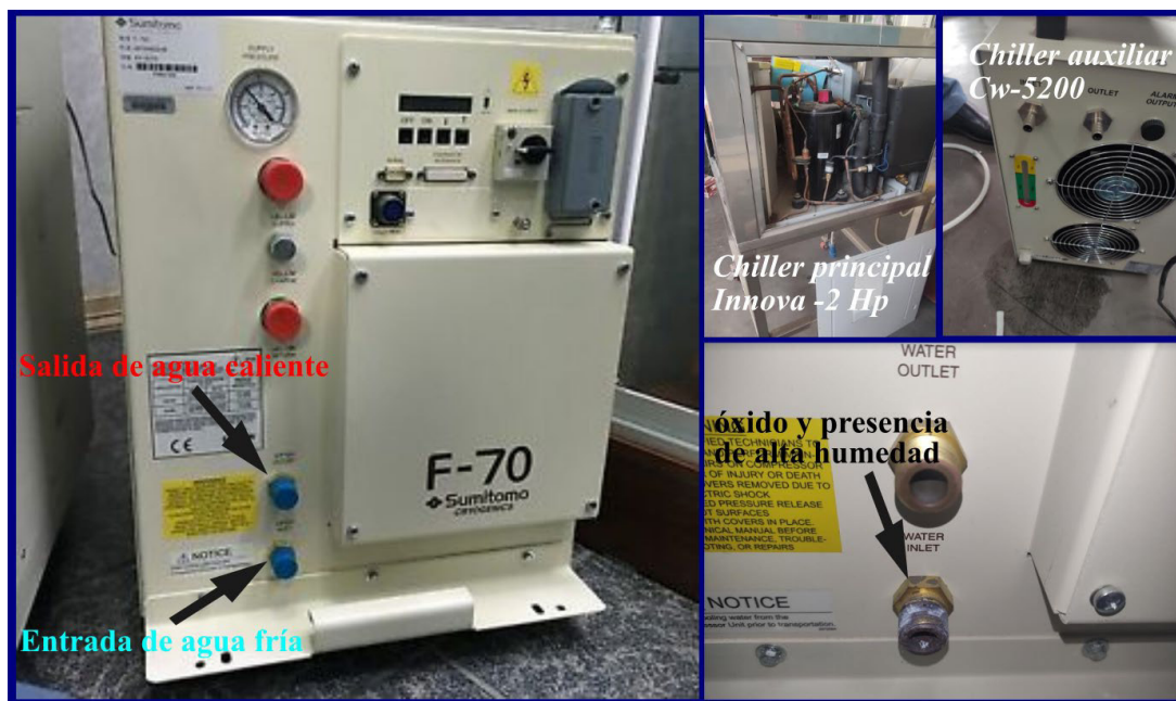
Figura 27. Condiciones iniciales del módulo de enfriamiento del compresor F-70L y el sistema chiller.
