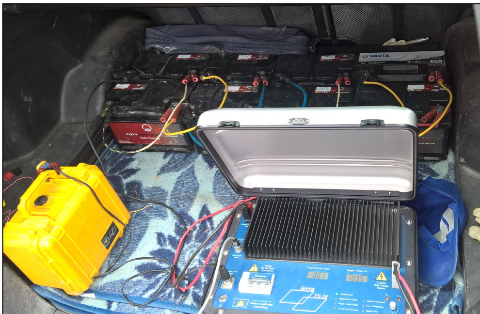
Figura 3.7: Conexión del Equipo TerraTx-50 de Monex GeoScope con sus 8 baterías y su batería de alimentación del equipo.
