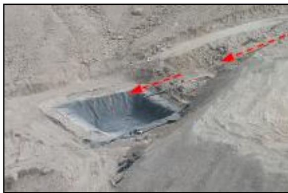
Fig 40.- Poza colectora de aguas, final.
