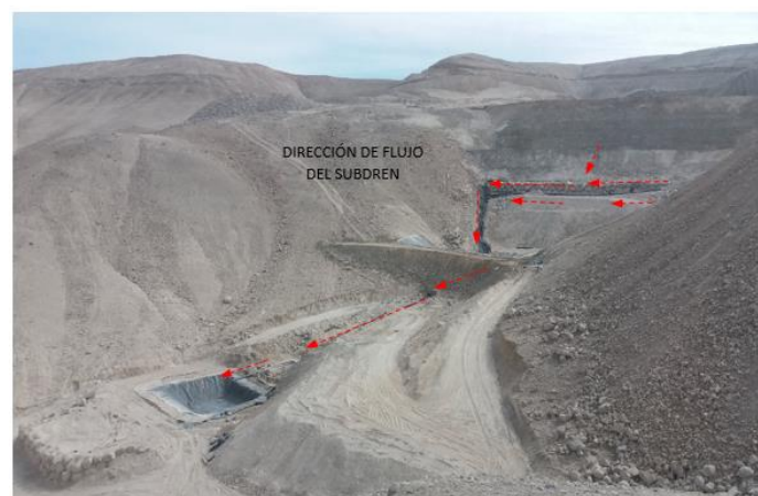
Foto N°152: Panorámico de la línea de subdrenaje completo y direcciones de flujo.
